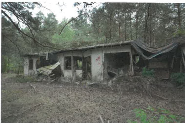
Exemplarisch abrisssreife Gebäude
