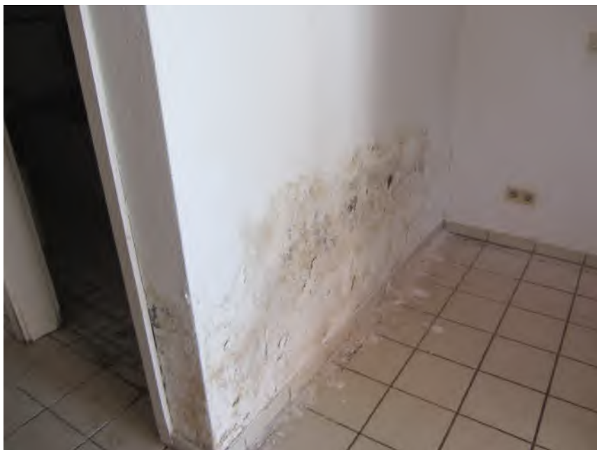
Bild 46: Gebäude 4, Whg. 3, DG, Nässeschaden/ Schimmel
