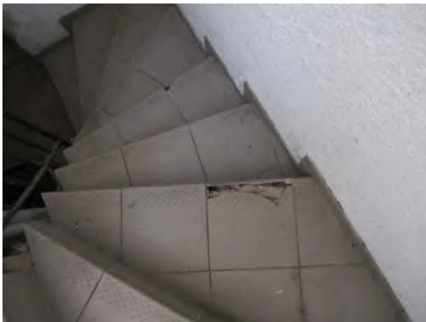
Bild 28: Gebäude 3, beschädigte Bodenfliesen im Treppenhaus
