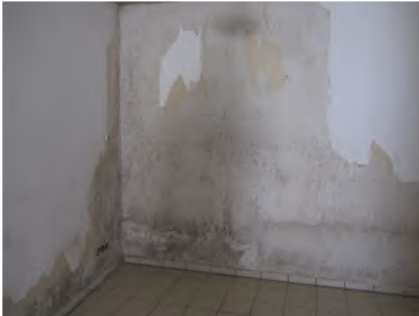
Bild 53: Gebäude 4, Whg. 1, EG, Nässeschaden/ Schimmel
