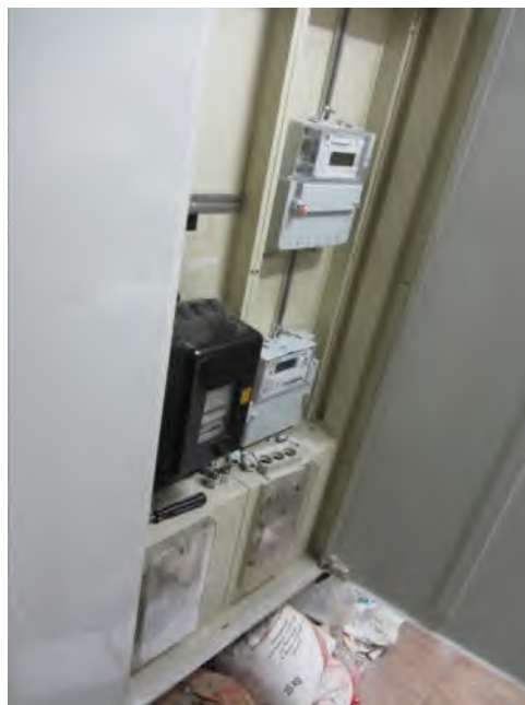
Bild 30: Gebäude 3, Stromzähler im KG
