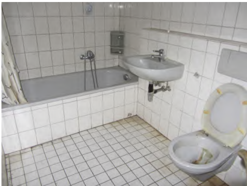
Bild 54: Gebäude 4, Whg. 1, EG, Bad
