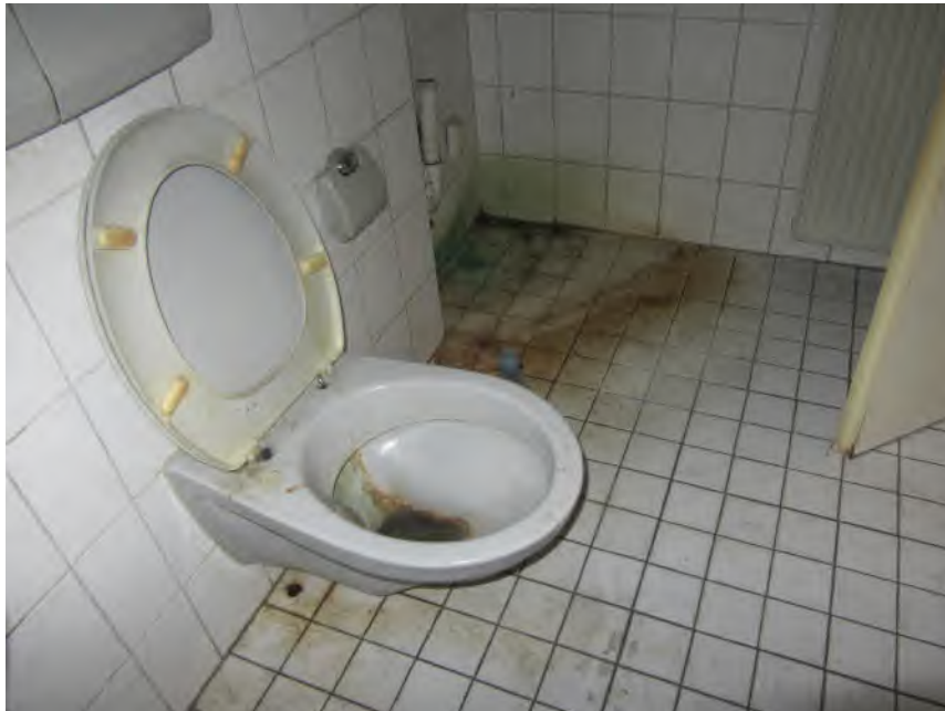
Bild 55: Gebäude 4, Whg. 1, EG, Bad
