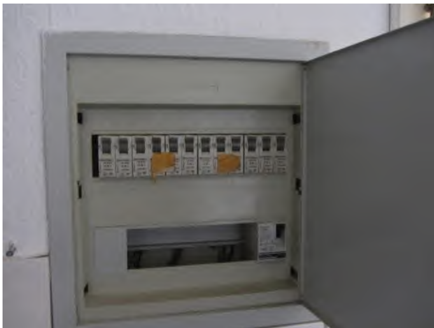
Bild 60: Gebäude 4, Whg. 1, EG, Elektro-Unterverteilung
