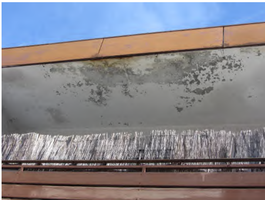
Bild 18: Gebäude 2, Nässeschäden im Dachbereich
