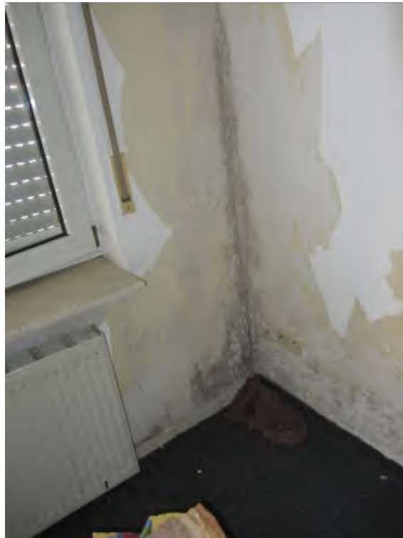
Bild 57: Gebäude 4, Whg. 1, EG, Nässeschaden/ Schimmel
