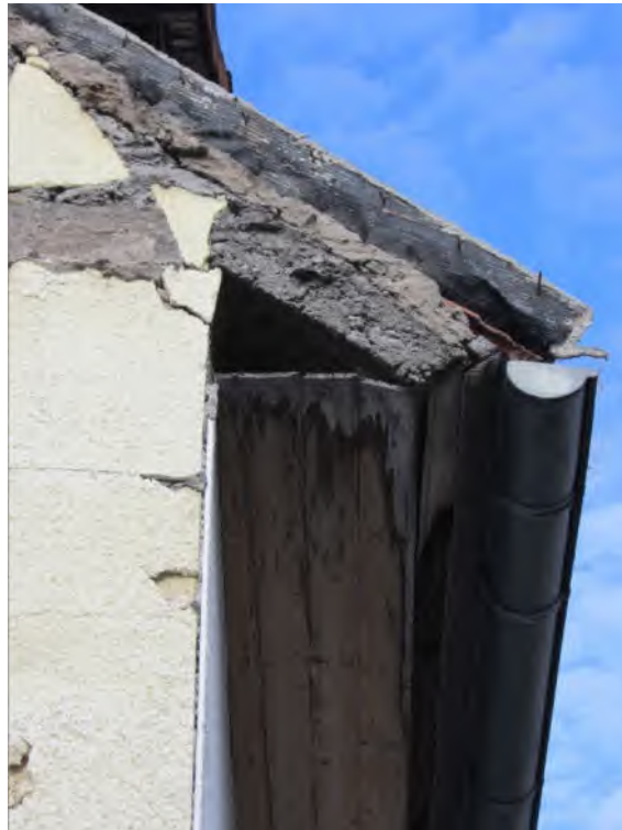
Bild 37: Gebäude 4, Zustand Traufbereich
