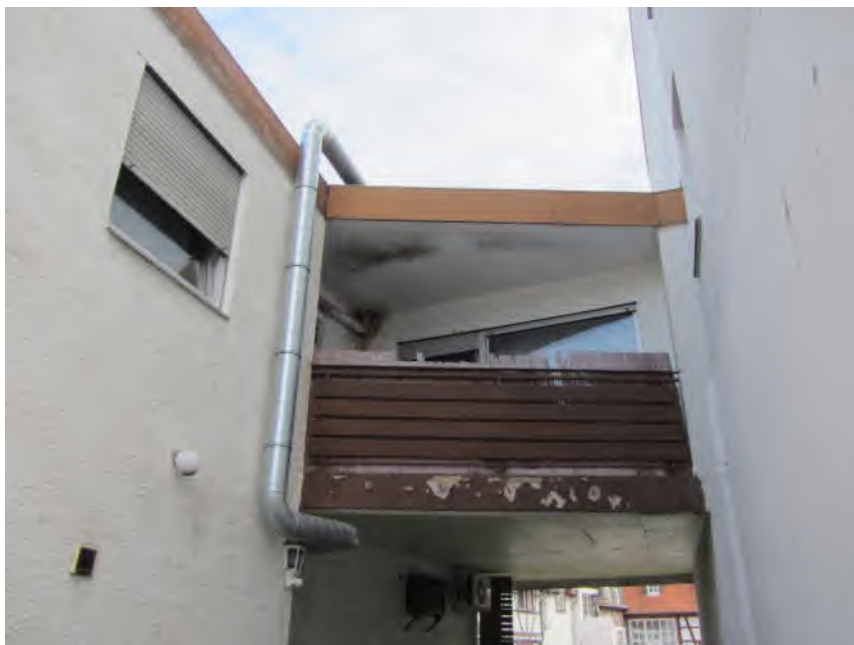
Bild 14: Gebäude 2, Nässeschäden im Dachbereich
