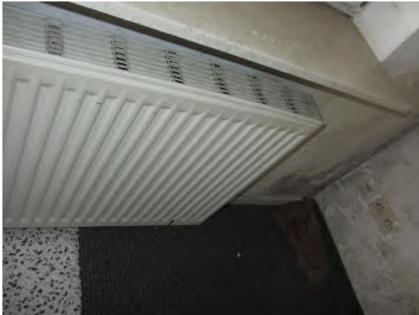
Bild 59: Gebäude 4, Whg. 1, EG, Zustand Heizkörper
