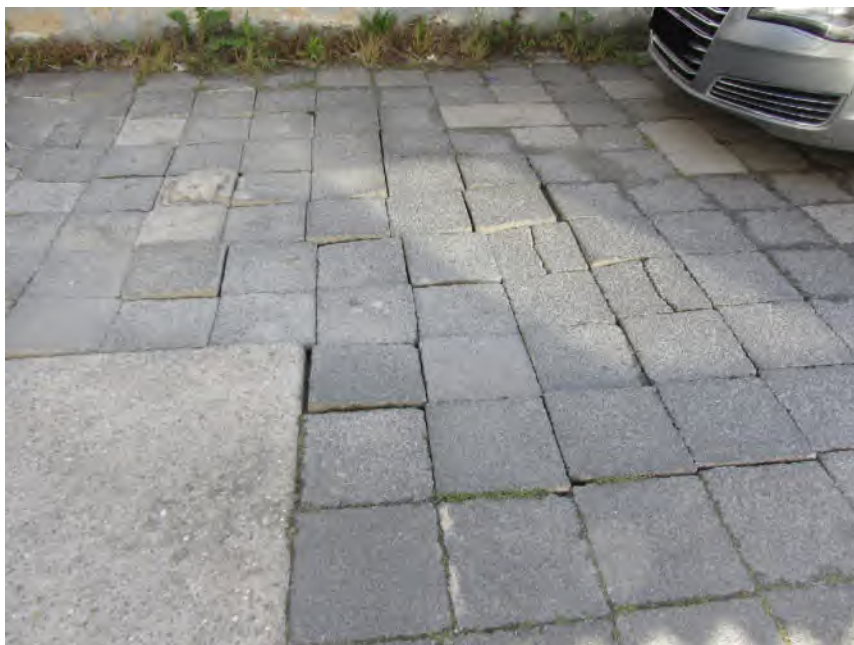
Bild 62: Hoffläche, Plattenbelag uneben und gebrochen
