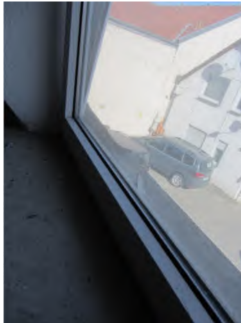
Bild 43: Gebäude 4, Whg. 3, DG, Zustand PVC-Fenster
