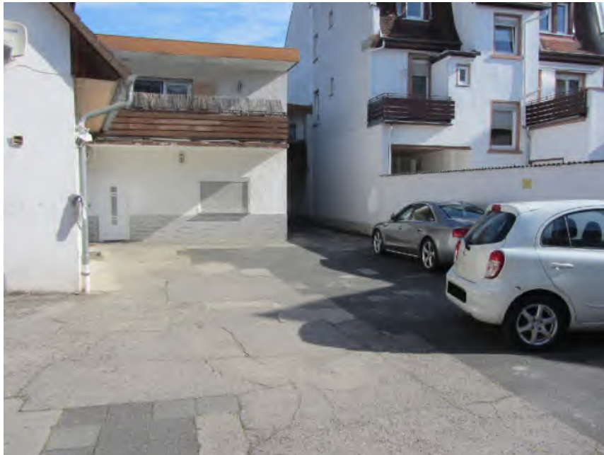
Bild 61: Hoffläche mit Beschädigungen
