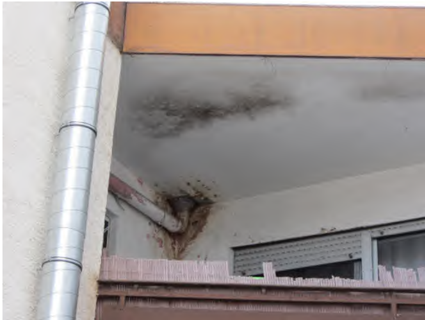
Bild 15: Gebäude 2, Nässeschäden im Dachbereich
