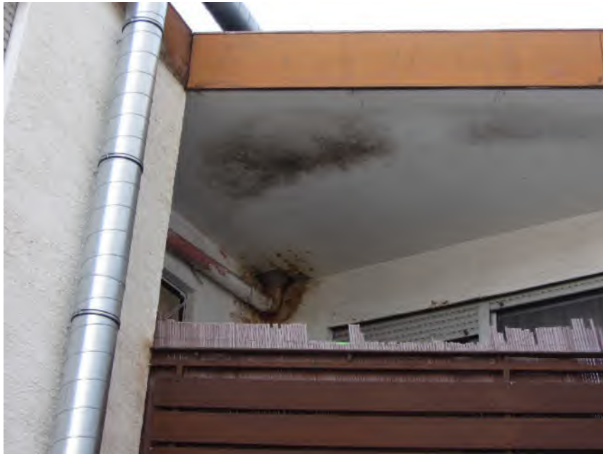
Bild 19: Gebäude 2, Nässeschäden im Dachbereich
