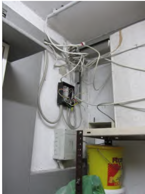
Bild 31: Gebäude 3, Telekommunikationsanschluss im KG
