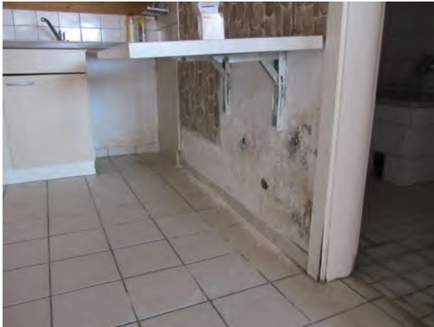
Bild 47: Gebäude 4, Whg. 3, DG, Nässeschaden/ Schimmel
