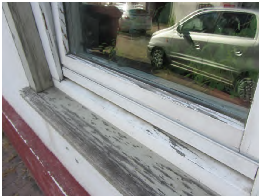
Bild 4: Gebäude 1, Zustand Holzfenster
