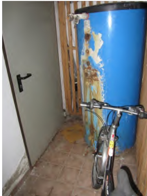
Bild 29: Gebäude 3, Flurbereich KG vor Heizungskeller (kein Zugang)
