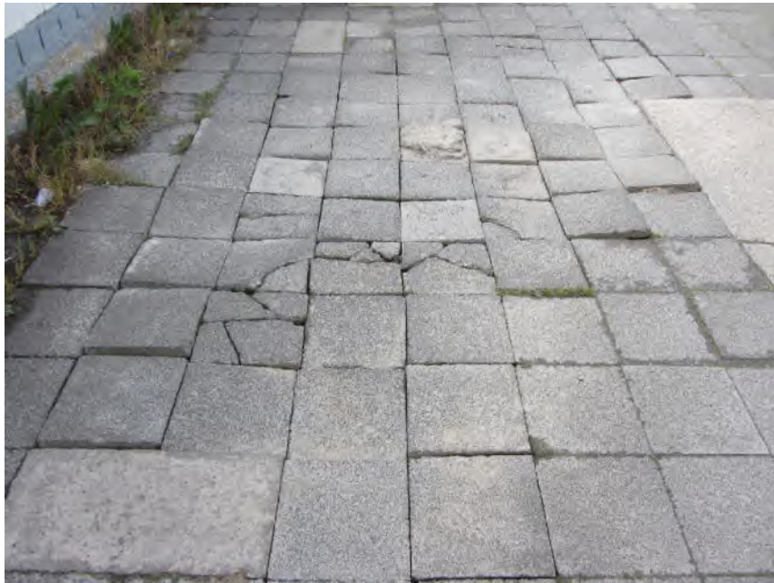
Bild 63: Hofffläche, Plattenbelag uneben und gebrochen
