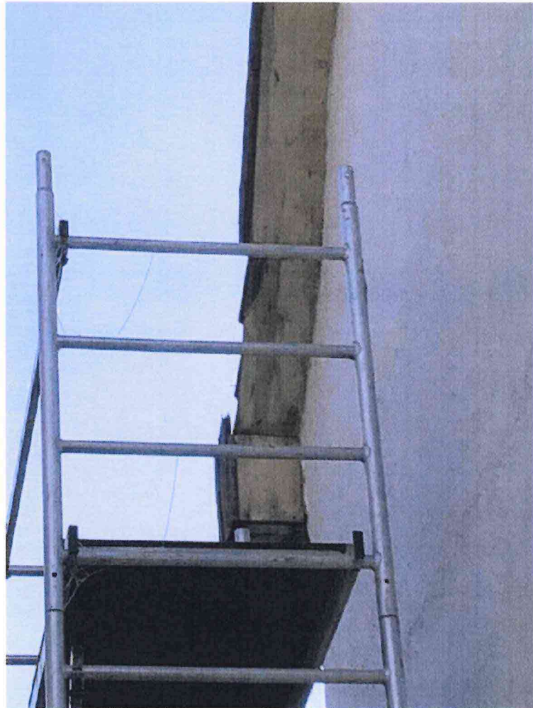
Bild 9 Schäden Ortgang Wohnhaus
