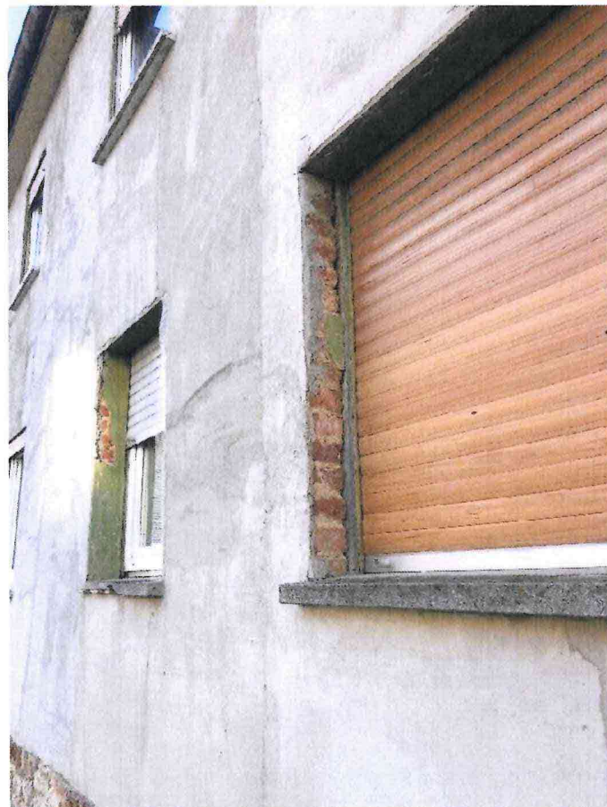
Bild 8 Verputz Fensterleibung fehlt
