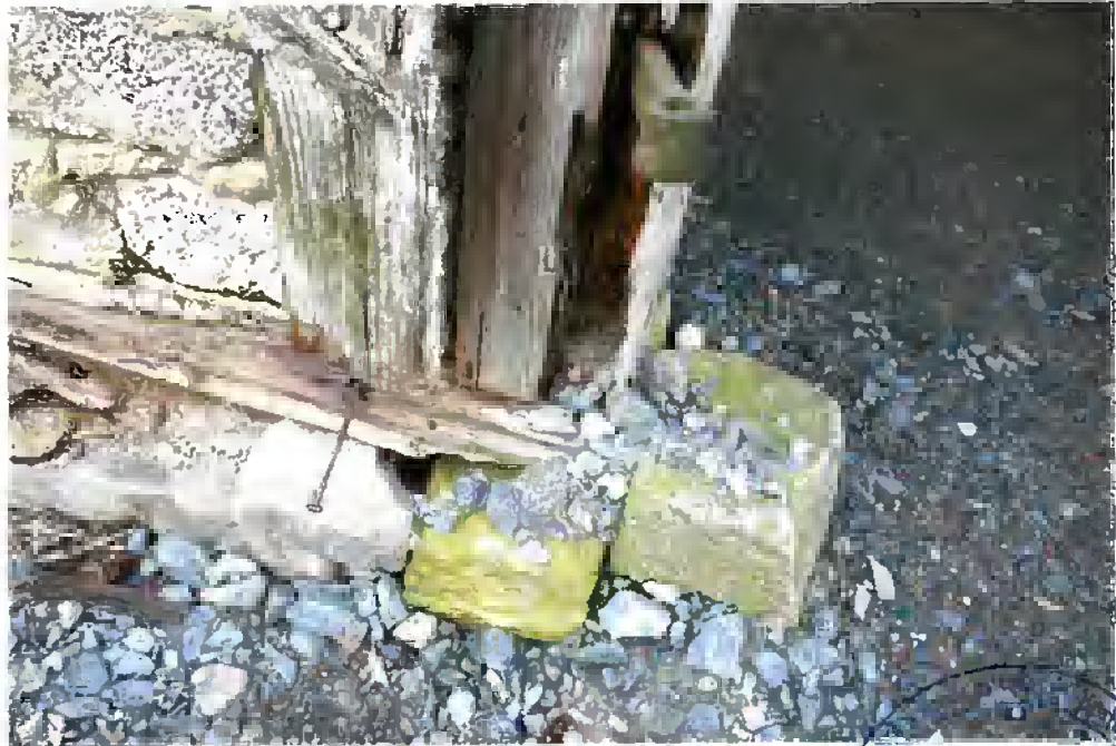
Bild 7: z. T. erhebliche Holzschädigungen
