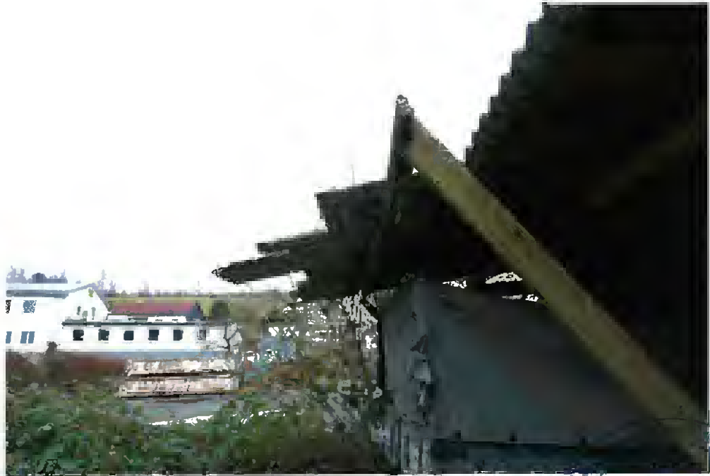
Bild 5: Unterstand Eindeckung mit asbesthaltigen Wellenplatten (defekt)
