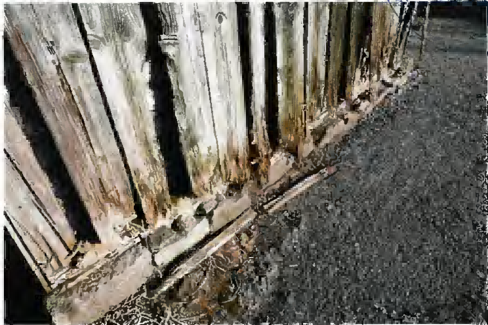
Bild 6: z. T. erhebliche Holzschädigungen
