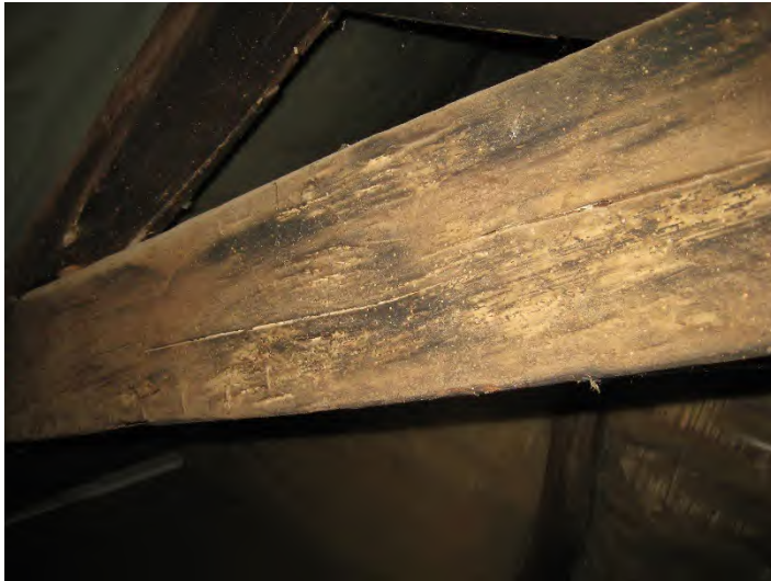
Bild Nr. 9, der Balken ist wurmstichig. Tragfähigkeit überprüfen wird empfohlen. Siehe Nr. 6.9.
