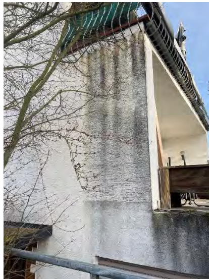
Verfärbungen an der Fassade
