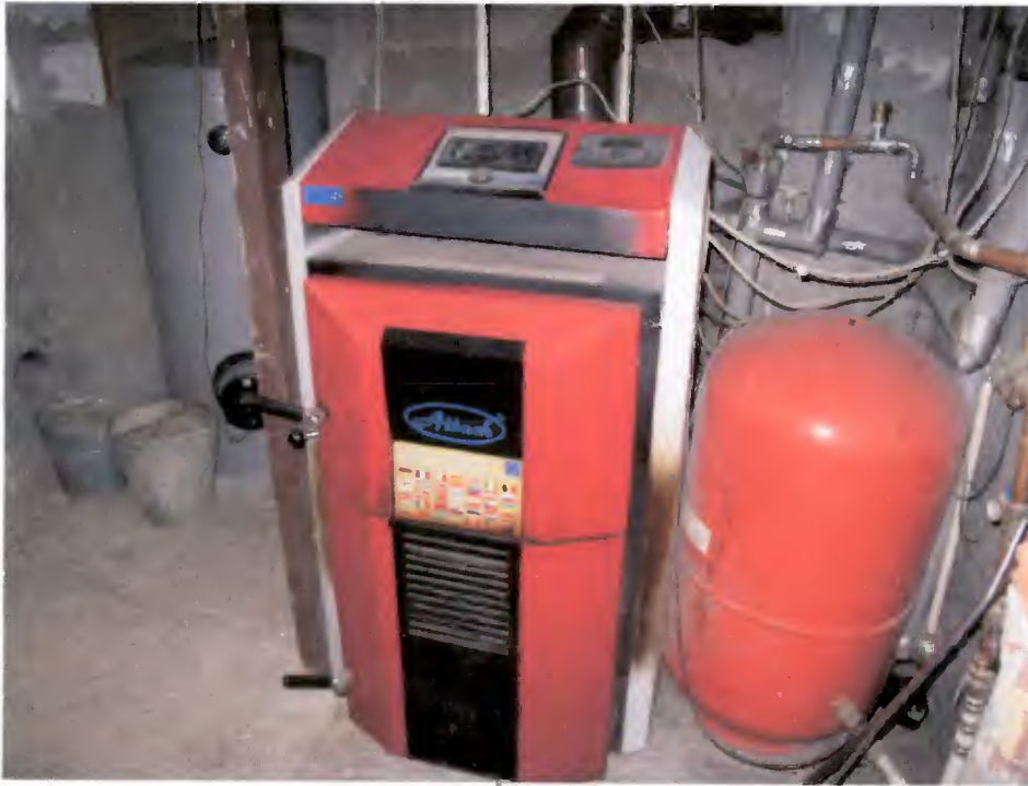
Foto Nr. 13: KG, Heizungsanlage
