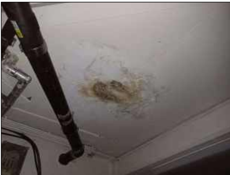
Abb. 42: Keller, Feuchteschäden an Decke (im Bereich unter der Küche)
