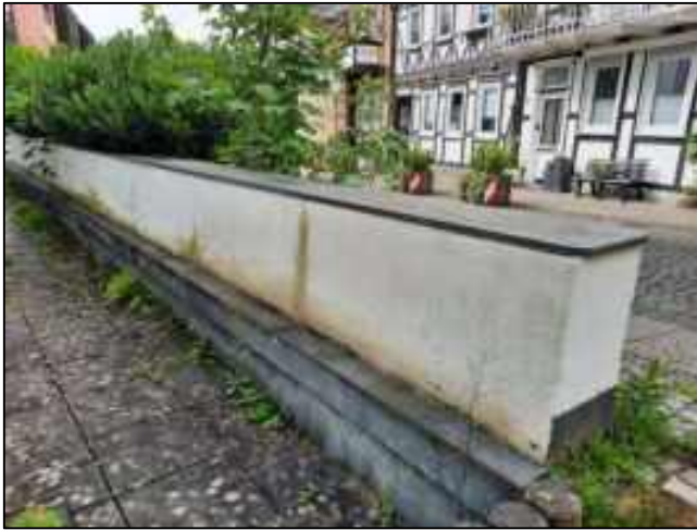
Abb. 28: Stützmauer an Rampe mit Feuchteschäden
