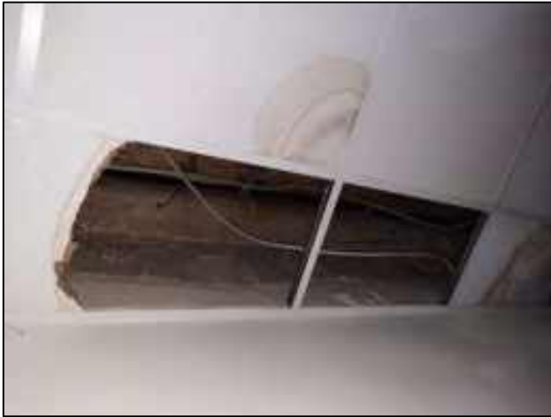
Abb. 40: Keller, Feuchteschäden an abgehängter Decke
