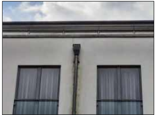
Abb. 37: Anbau, Fassade mit Feuchteschäden
