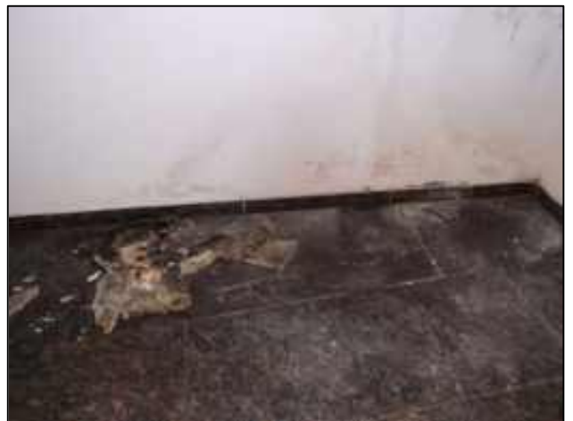
Abb. 41: Keller, Feuchteschäden/Schimmel an Wand
