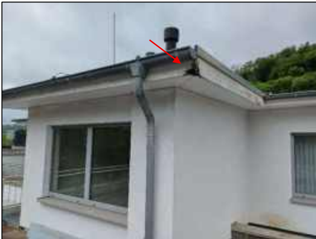
Abb. 38: Anbau, Schadstelle an Dacheindeckung
