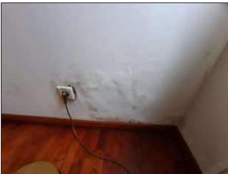
Abb. 43: 2. OG Zimmer, Feuchteschäden an Innenwand im Bereich Steckdose
