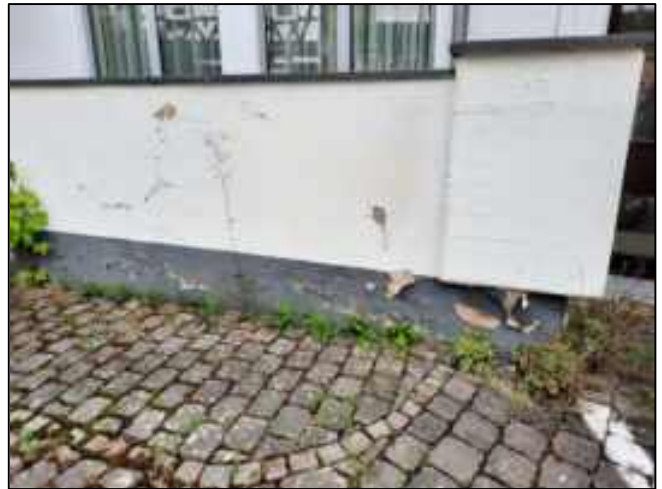
Abb. 29: Stützmauer an Rampe mit Feuchteschäden
