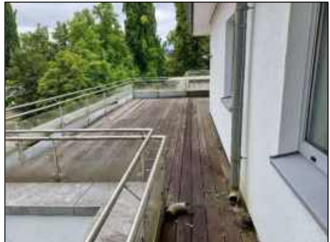
Abb. 39: Schadstelle an Dachentwässerung
