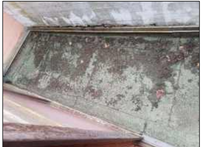
Abb. 31: Altbau 2. OG, Balkon mit Feuchteschäden
