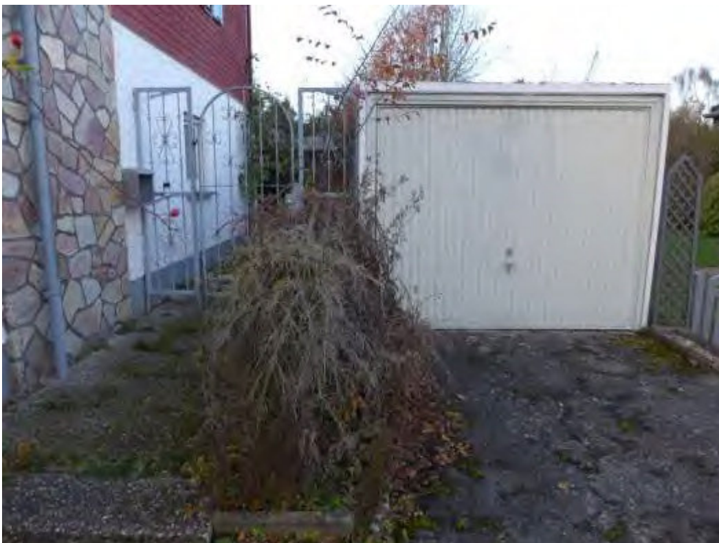
18 Zustand Befestigung, Zuwegung
