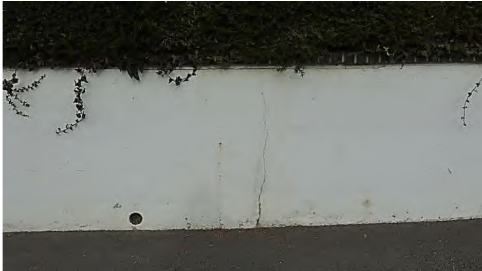
Einfriedungssockel mit partieller Rissbildung
