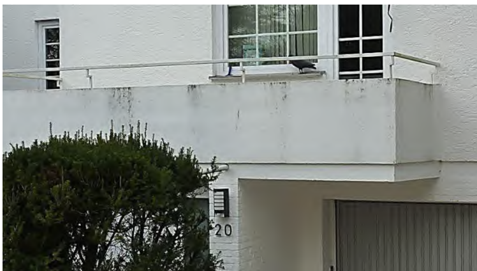
Balkonbrüstung mit witterungsbedingten Abnutz.erschein. / partiell Rissbildung
