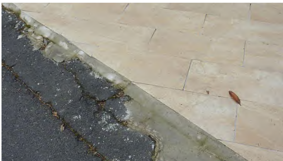
Randbereich Hofplattenbelag mit Ungenauigkeiten
