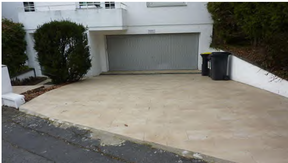
Garagenabfahrt / Garagentor mit Delle
