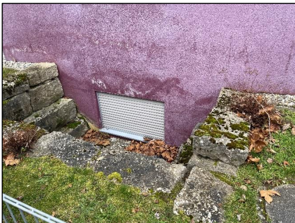
Ausblühungen KG – Ostfassade
