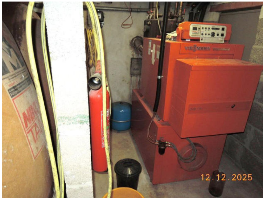
Bild 17: Heizung und Öltanks
