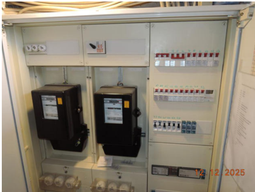
Bild 21: Zählerschrank im Kellergeschoss der Wohnung Nr. 1
