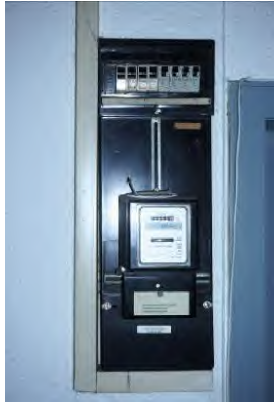
Elektroverteilung im Dachgeschoss
