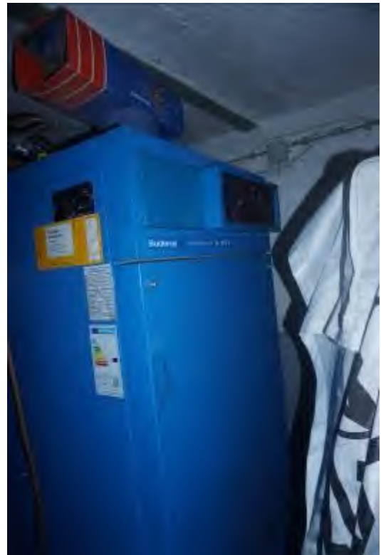
Stahl- Heizkessel Baujahr 1991
