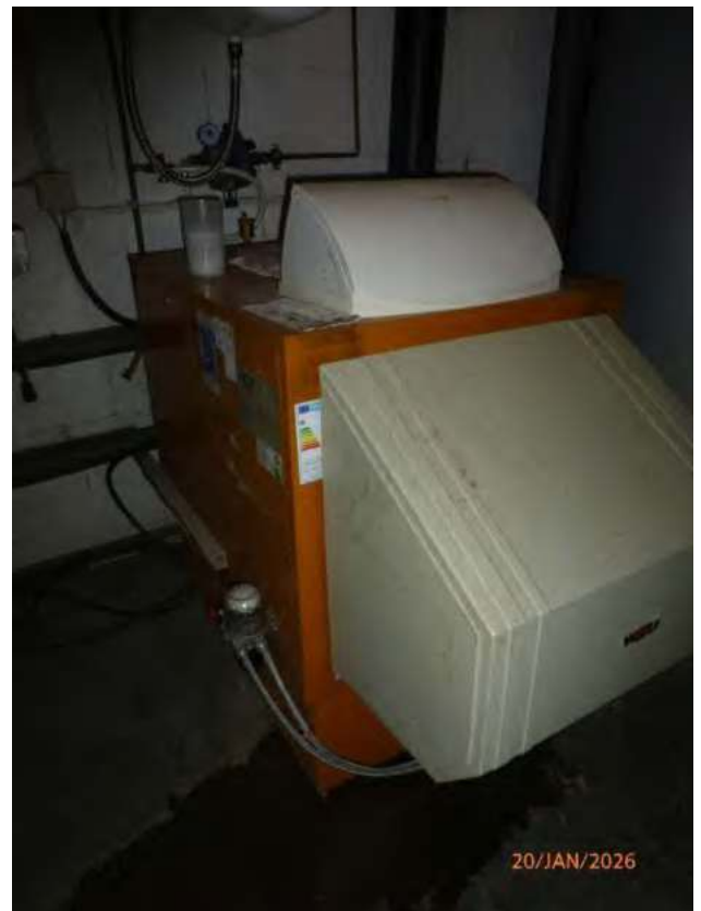
Zentralheizung im Keller
