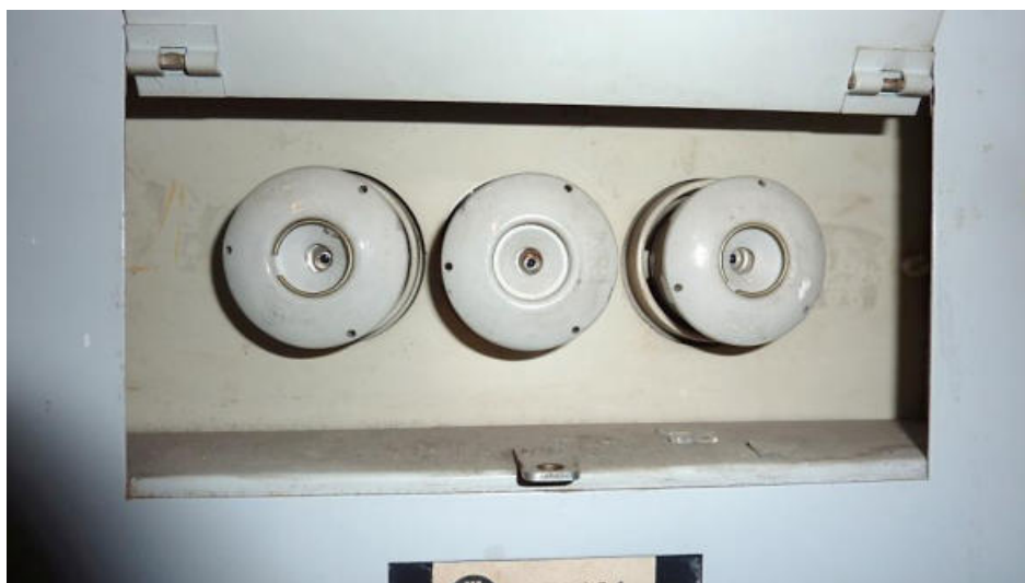
alter Elektrosicherungskasten im Zugangsflur vor der Wohnung
