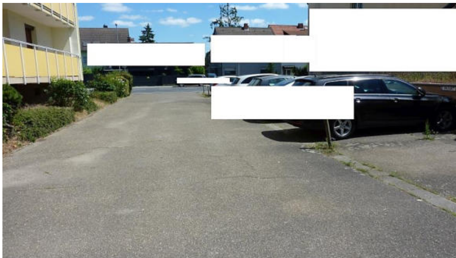
wenige PKW-Stellplätze im Freien / Asphaltbelag mit Abnutz.ersch. und Rissbildung
