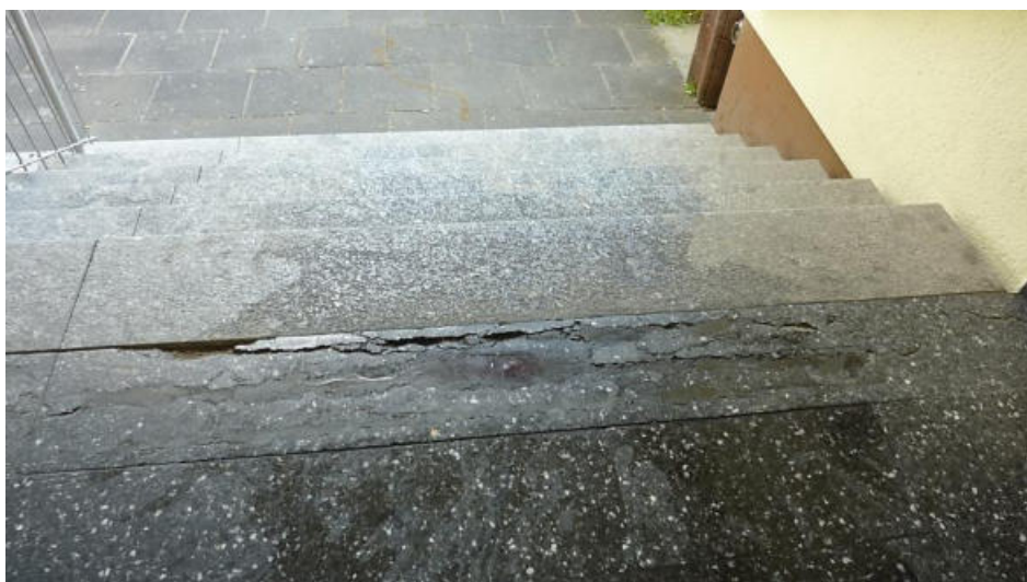
Schadstellen am Außeneingangsbelag
