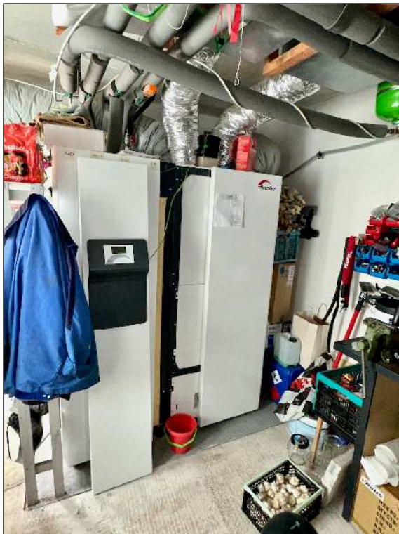
Foto 13 Erdgeschoss - Technikraum mit Wärmepumpe (separater Zugang von außen)
