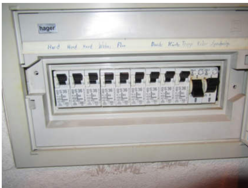
Bild 50: Sicherungskasten (unzureichende Absicherung)
