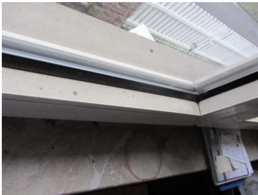
Bild 24: Zustand PVC Fenster
