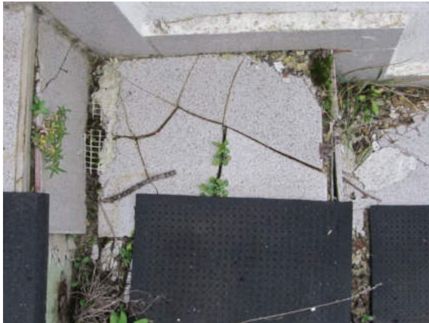
Bild 17: Gerissene Fliesen Zugang zu Balkon EG
