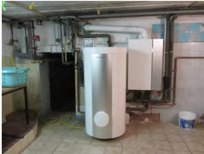
Bild 39: Zustand Gas-Zentral Heizung
