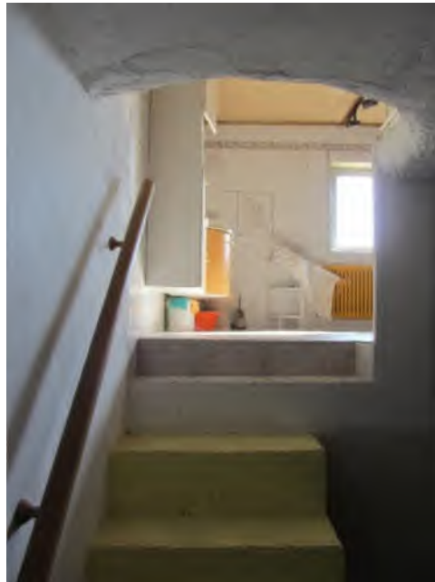
Bild 45: Treppe zum ausgebauten Teil des DG (ohne Genehmigung)
