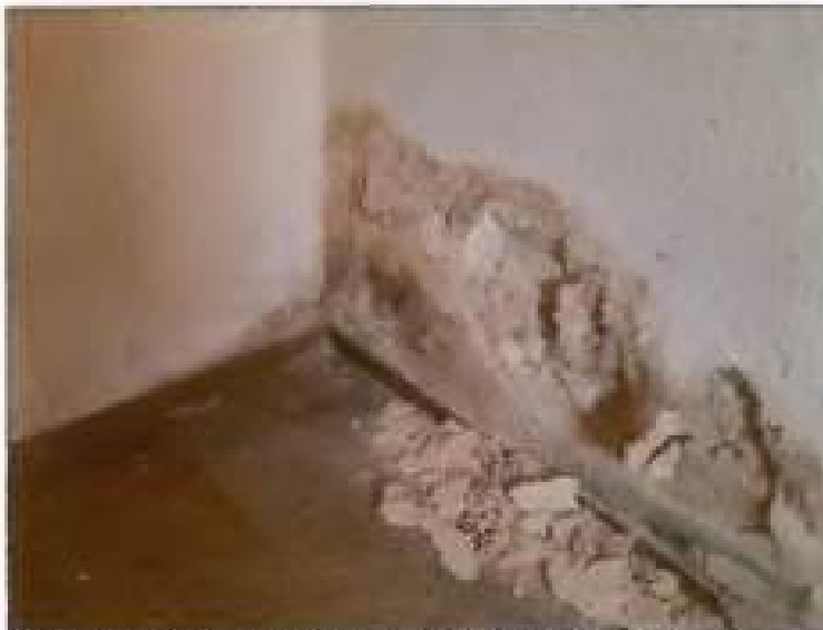
Abb. 17: Erdgeschoss, Schadstelle durch Wasserschaden
