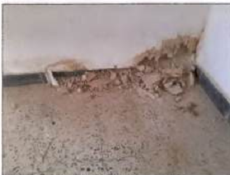
Abb. 18: Erdgeschoss, Schadstelle durch Wasserschaden
