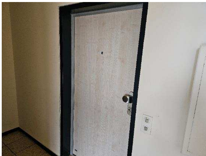
Wohnungseingangstüre der bewertungsgegenständlichen Eigentumswohnung
