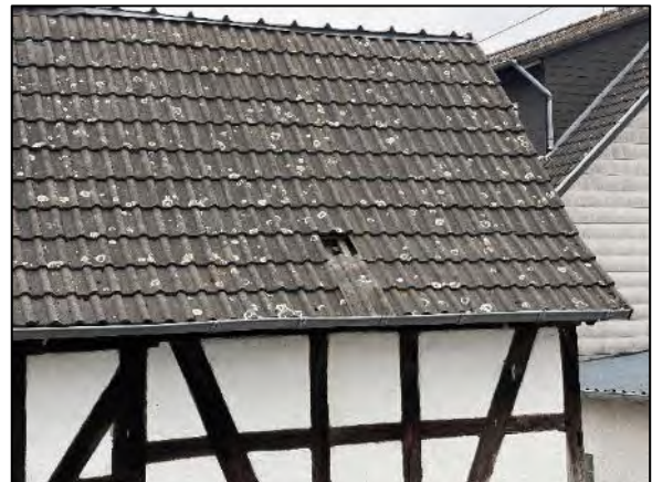
Schäden Dach Einfamilienhaus
