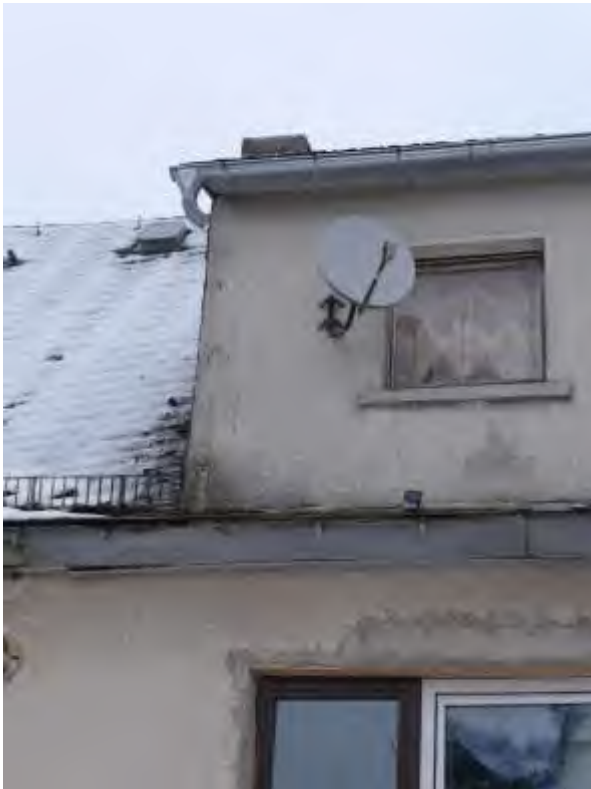
15 a Fassadendetail, Schäden an Holzteilen
