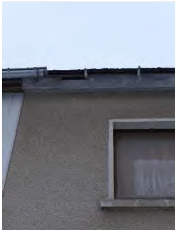
12 b fehlende Dachrinne
