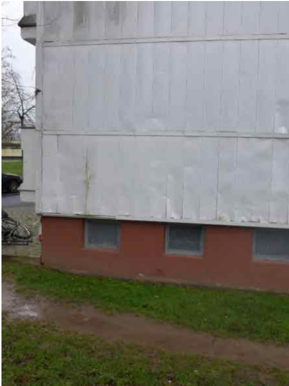
9 a Beispiel Zustand Fassade
