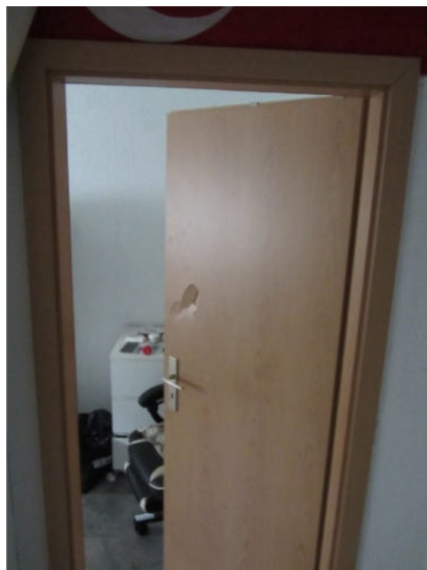
Bild 20: Zustand Innentüren (mit Beschädigung)
