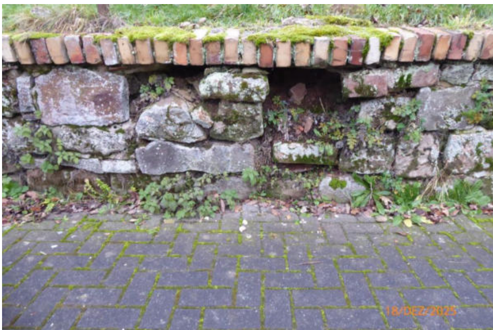
Foto 16: baufälliger Zustand der Gartenmauer entlang der Bachstraße
