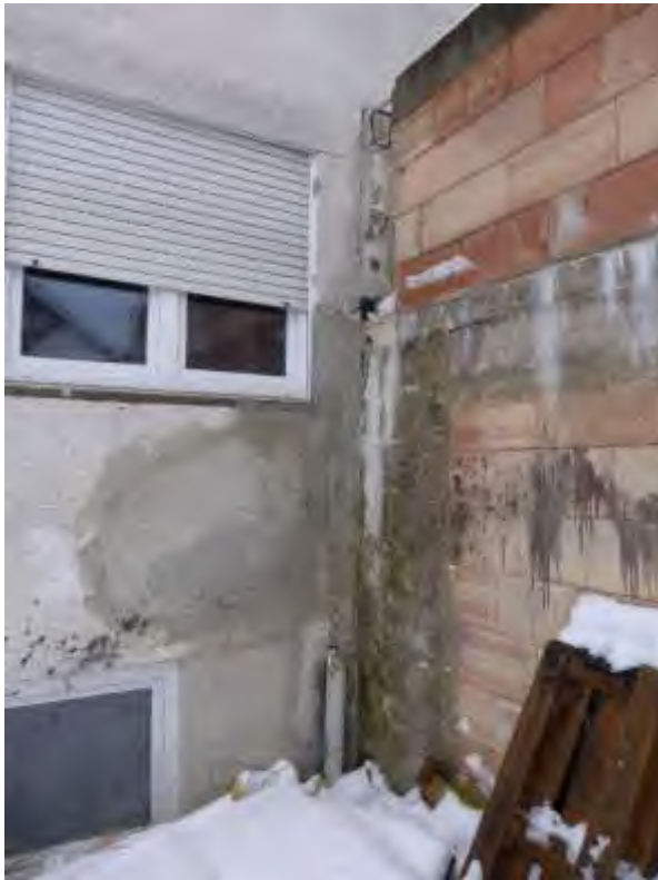
33 a Feuchte- und Herstellungsschäden
