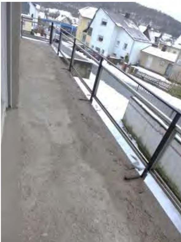
24 a Zustand Balkon 1. OG
