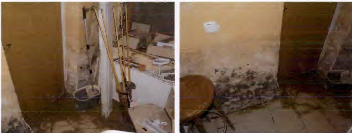
Wasserschaden Kellerbereich – hinteres Gebäude
