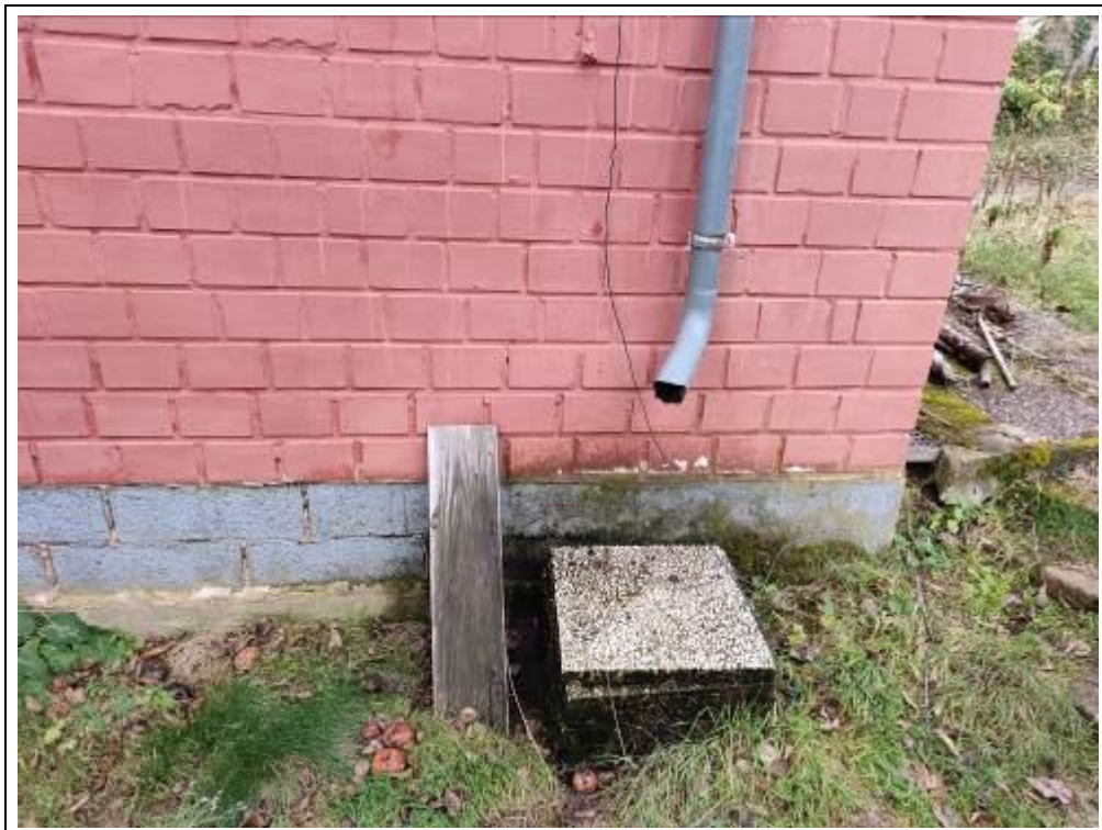
Blick auf das nicht angeschlossene Regenfallrohr
