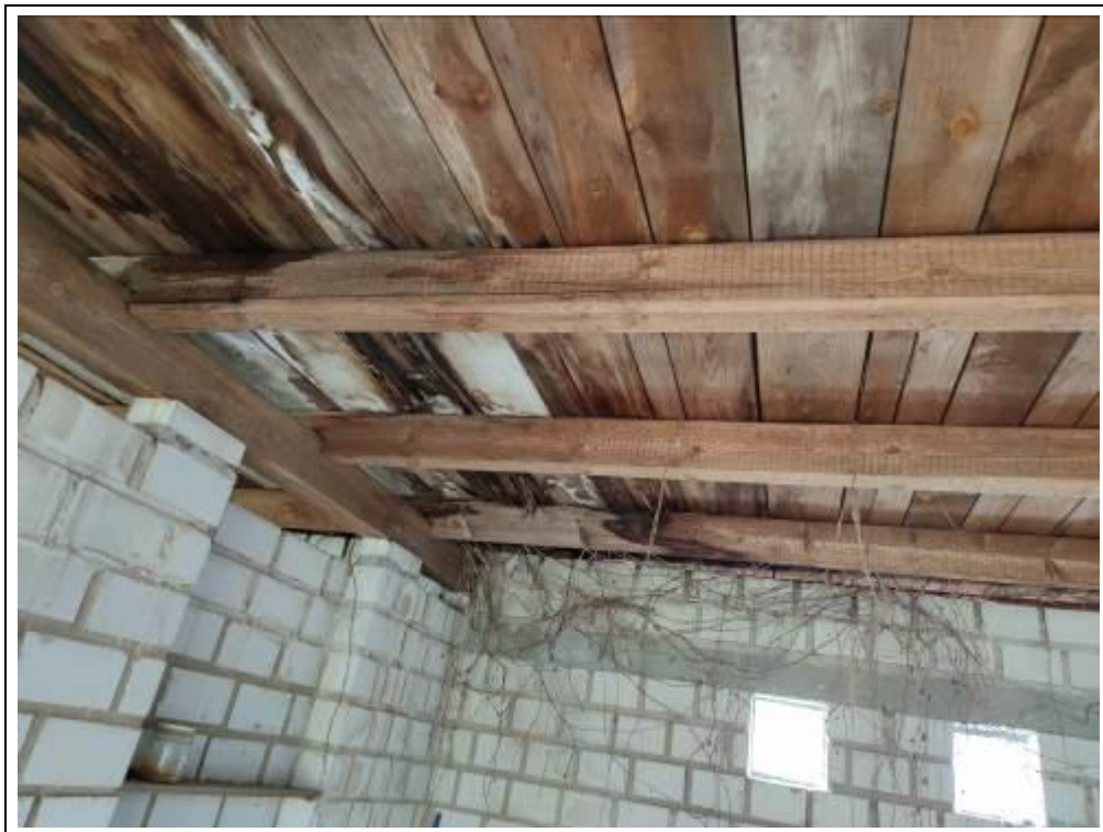
Blick gegen die Dachuntersicht mit Holzverschalung und Feuchtigkeitsschäden durch undichte Dacheindeckung
