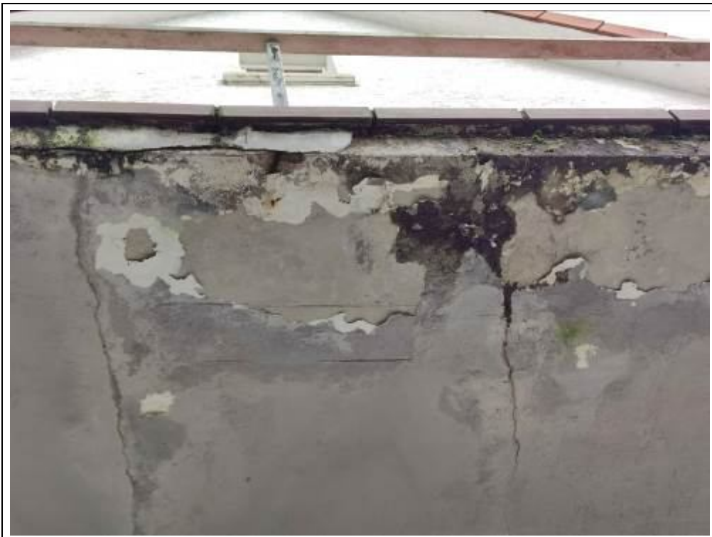
Blick auf Schäden an der Balkonplatte
