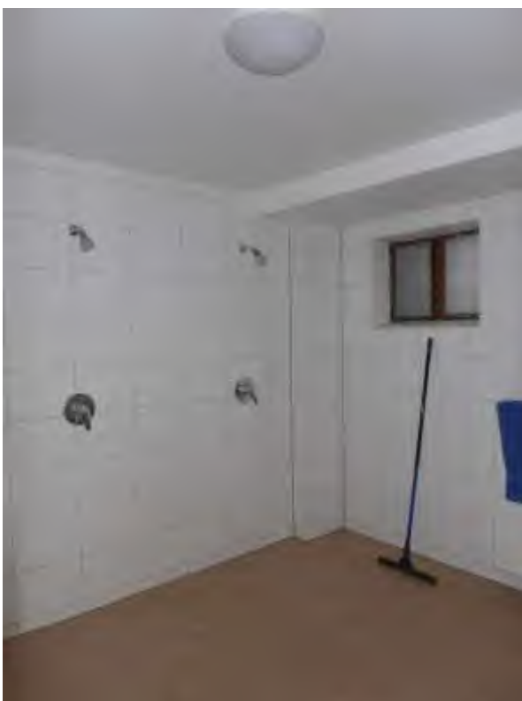
30 a Dusche KG Halle
