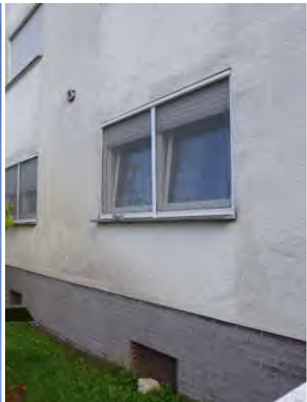
36 b Zustand Fassade
