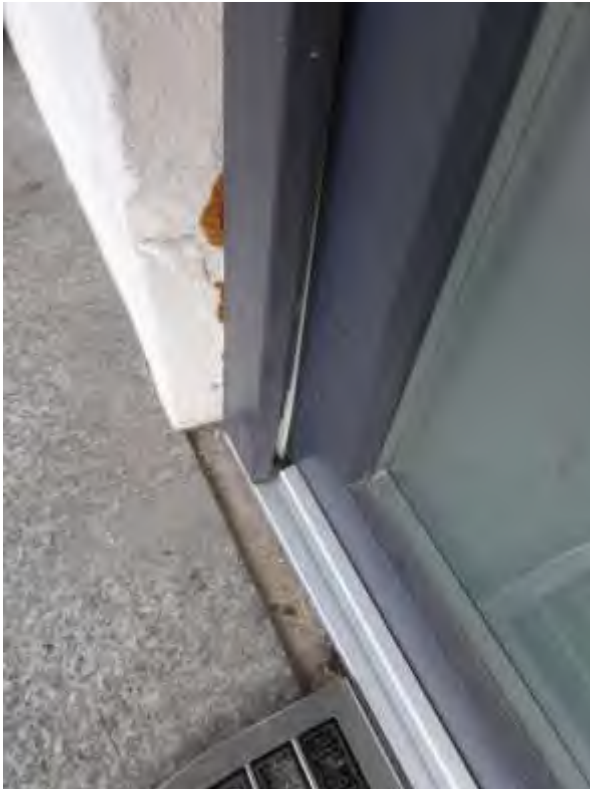
31 a mangelhaft eingebaute Eingangstür
