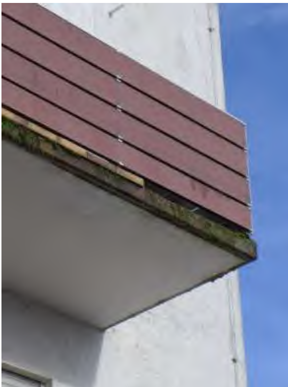
36 a schadhafter Balkon
