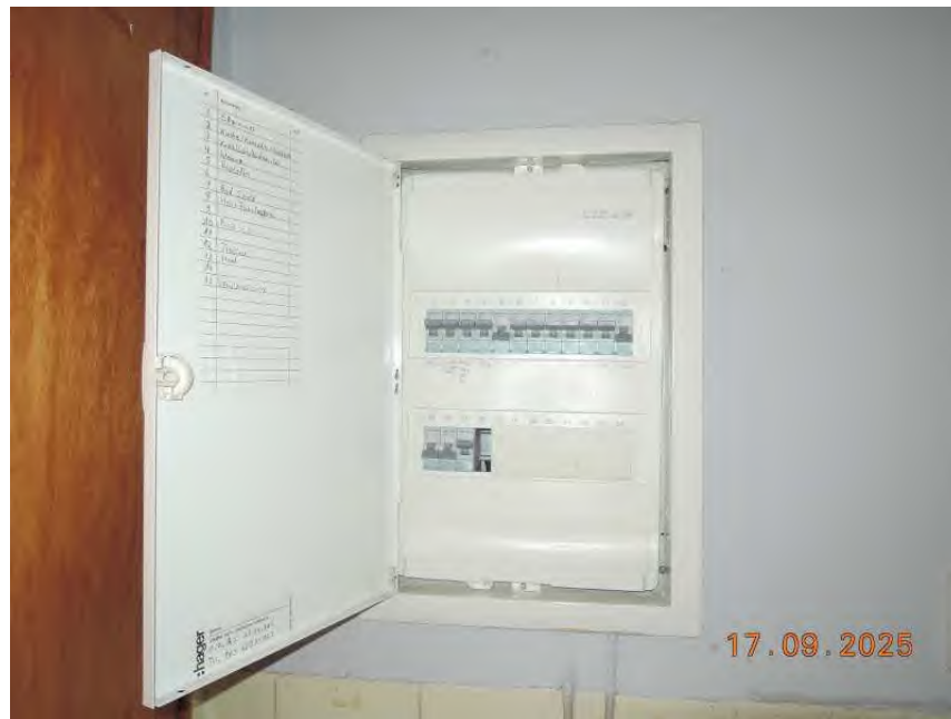
Bild 11: Sicherungskasten der Wohnung im Obergeschoss
