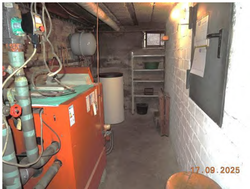
Bild 20: Heizungsraum mit Zugang zum Öltankraum
