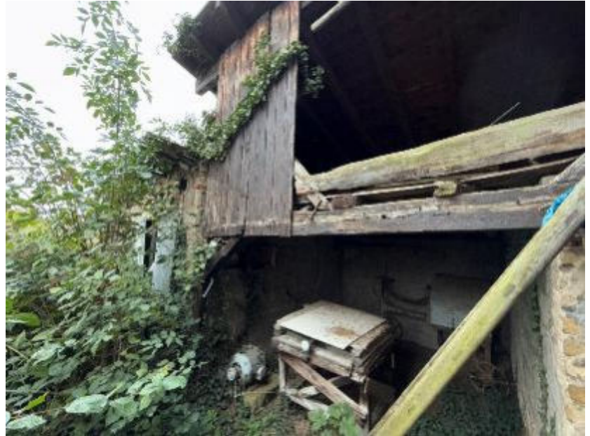
Abb. 17: Foto des SV; Schuppen z.T. schadhaft
