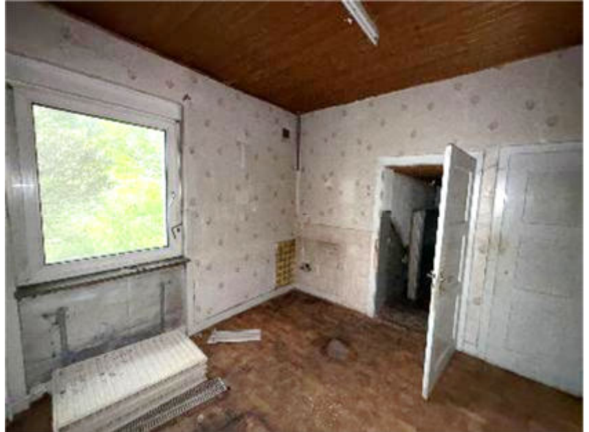
Abb. 11: Foto des SV; Raumboerflächen überaltert/schadhaft (Küche EG, Heizkörper schadhaft und demontiert)
