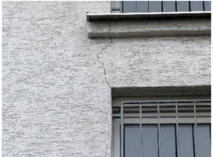
Abb. 1: Foto des SV; z.T. Fassade mit Putzrissen
