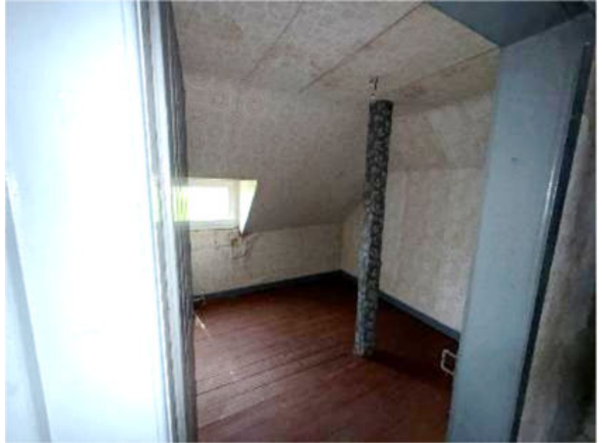
Abb. 15: Foto des SV; Raumbooberflächen überaltert/schadhaft, (Kammer DG)
