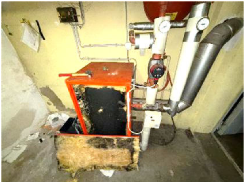
Abb. 6: Foto des SV; Heizungsanlage überaltert/schadhaft
