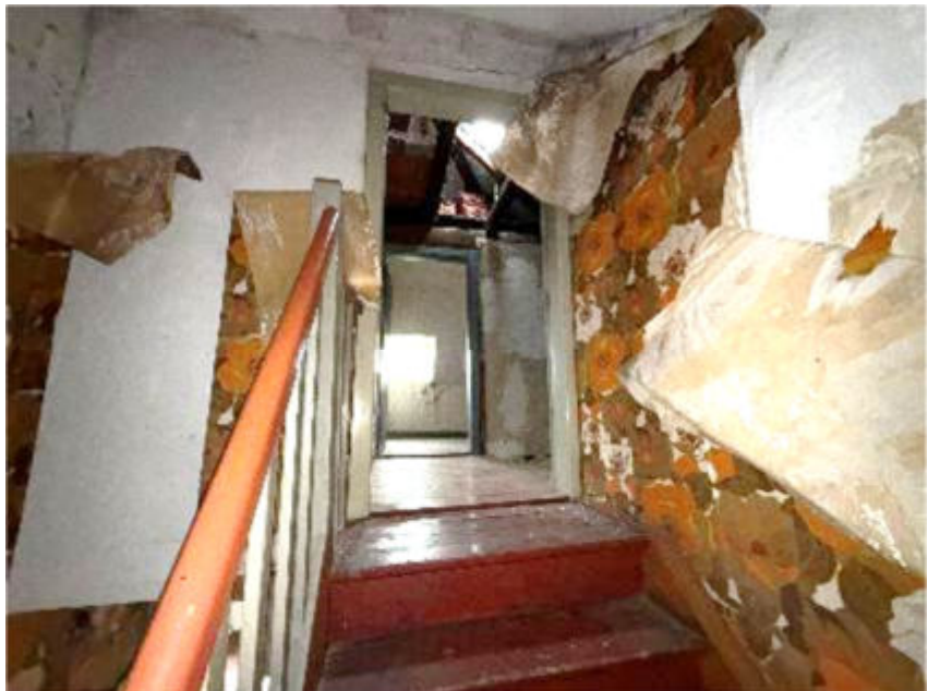
Abb. 10: Foto des SV; Raumboflächen überaltert/schadhaft (Treppe)
