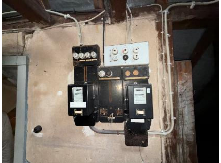
Abb. 5: Foto des SV; Elektroinstallationen überaltert
