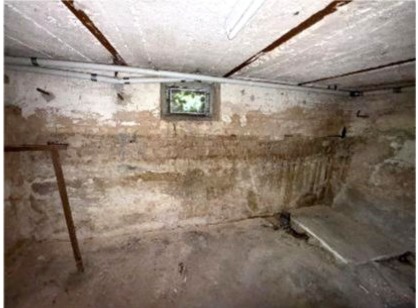
Abb. 3: Foto des SV; z.T. Feuchteschäden der Keller-Außenwände
