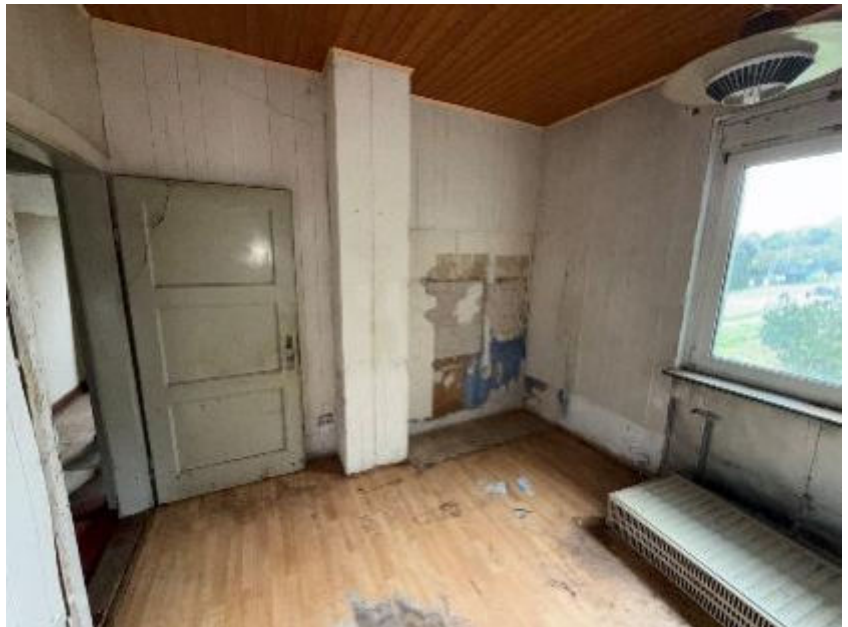
Abb. 14: Foto des SV; Raumboerflächen überaltert/schadhaft, Heizkörper schadhaft und demontiert (Küche OG)
