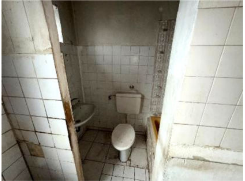
Abb. 9: Foto des SV; z.T. Sanitäranlagen überaltert (Bad OG)
