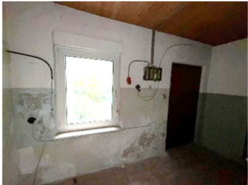
Abb. 4: Foto des SV; z.T. Feuchteschäden der Außenwände des Anbaus
