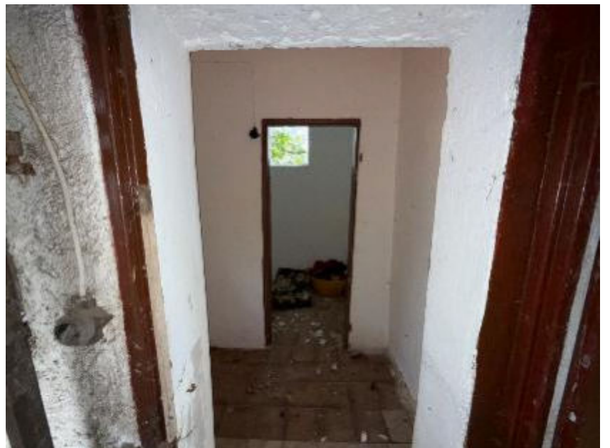
Abb. 16: Foto des SV; schadhafte Raumbooberflächen (Lager)
