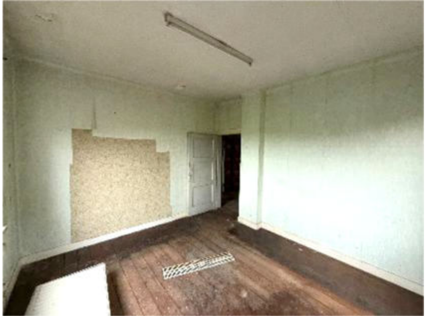
Abb. 13: Foto des SV; Raumboerflächen überaltert/schadhaft, Heizkörper schadhaft und demontiert (Zimmer OG)
