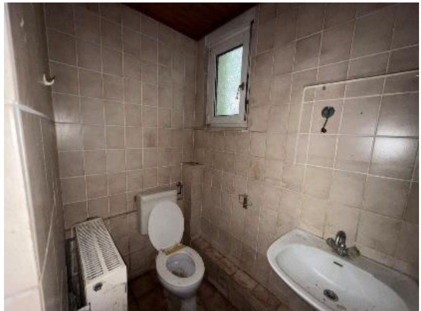
Abb. 8: Foto des SV; z.T. Sanitäranlagen überaltert (Bad EG, Anbau)
