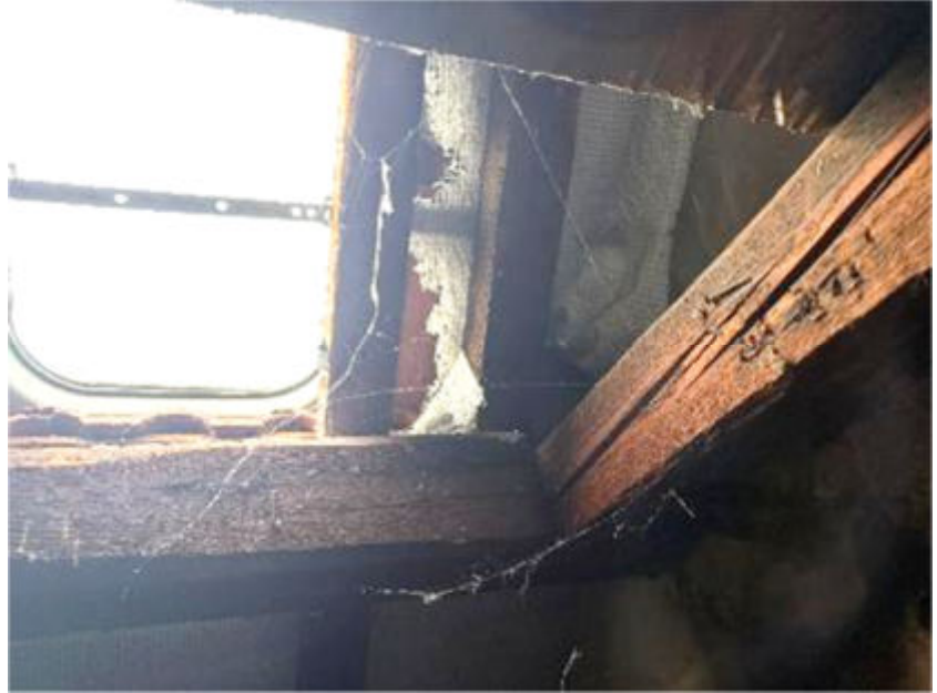
Abb. 7: Foto des SV; z.T. Dachunterspannbahn schadhaft/versprödet (DG)
