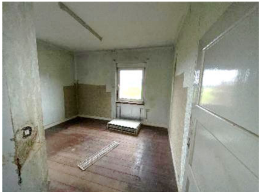
Abb. 12: Foto des SV; Raumboerflächen überaltert/schadhaft, Heizkörper schadhaft und demontiert (Zimmer OG)
