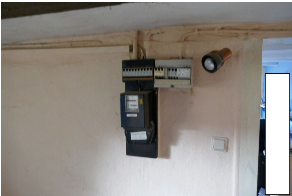
Bild_32_“Stromzähler im Flur (OG)“
