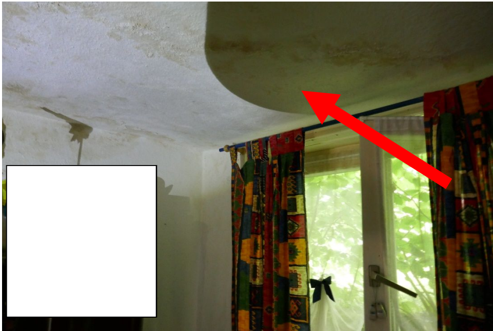
Bild_29_„Büro (EG)“; „Wasserschaden (darüber „Bad“)“
