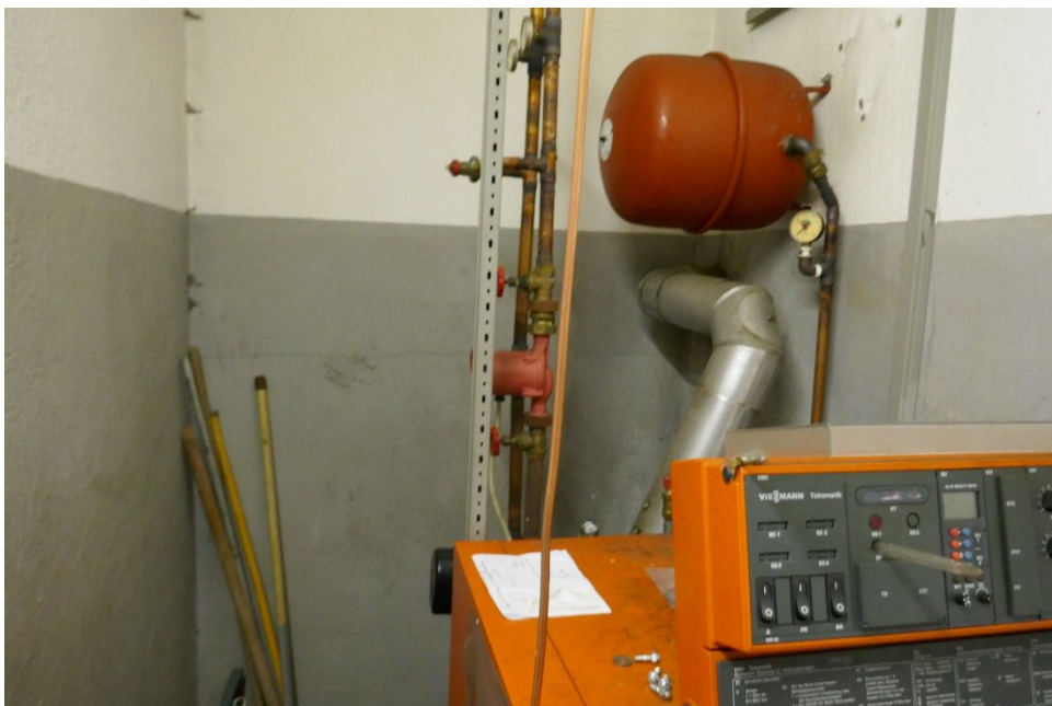
Bild_18_“Heizung (zum Zeitpunkt der Ortsbesichtigung defekt) im UG“
