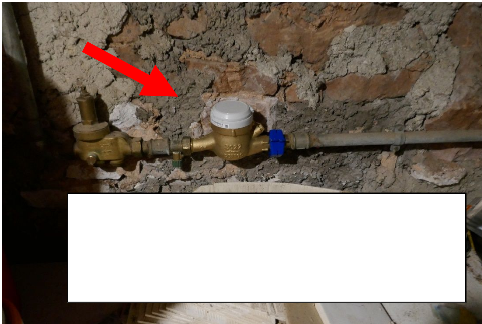
Bild_11_“Wasserzähler im Keller 1“ (UG)
