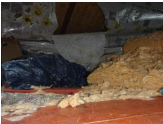
Schäden Dämmung Dachflächen
