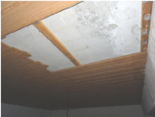
Schäden Holzdecke Wohn-/ Esszimmer
