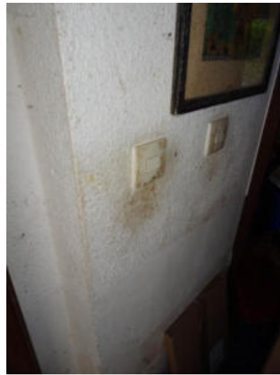
verschmutzte Schalter und Wandflächen
