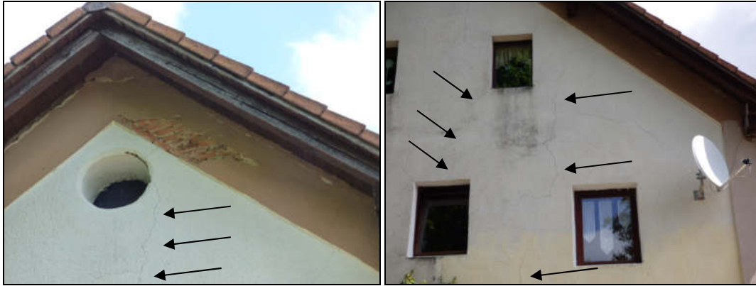
Südliche Giebelseite mit Fassadenrissen und Putzabplatzungen mit sichtbarer Ziegelmauerwerkstruktur
