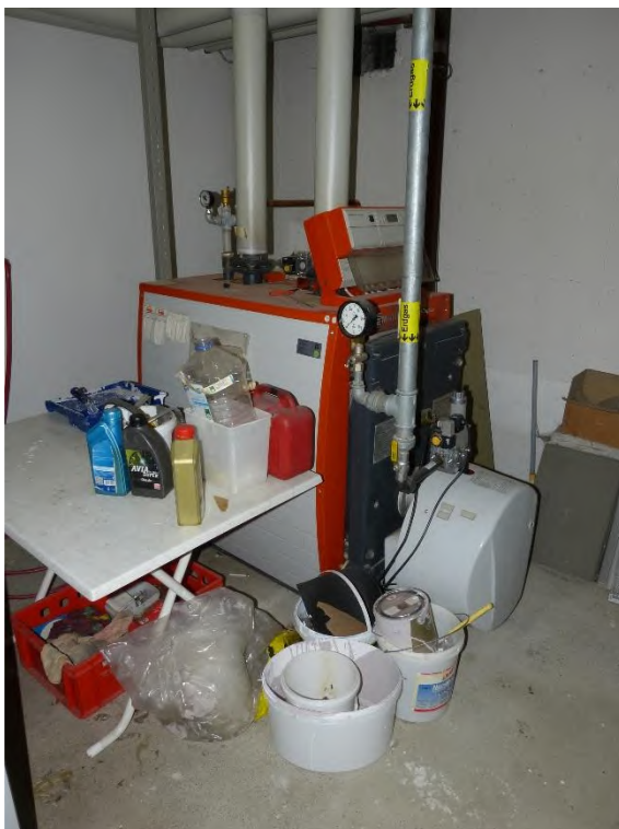
Gebäude 4: Ferienwohnanlage, Innenaufnahme Heizungsraum im Untergeschoss
