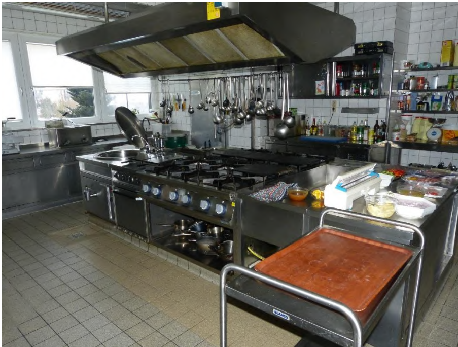
Gebäude 1: Hotelgebäude, Innenaufnahme Gastronomieküche im Erdgeschoss
