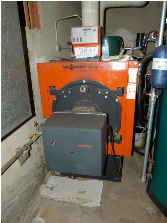
Gebäude 1: Hotelgebäude, Innenaufnahme Heizungsraum im Kellergeschoss
