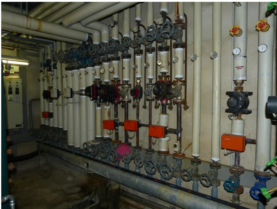
Gebäude 1: Hotelgebäude, Innenaufnahme Heizungsverteilung im Kellergeschoss
