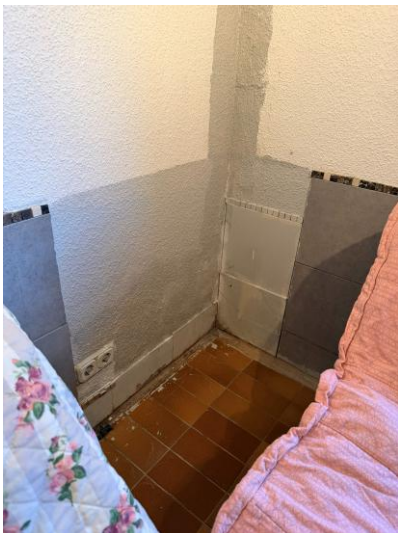
Feuchtigkeit im Zimmer – Wand bergseitig
