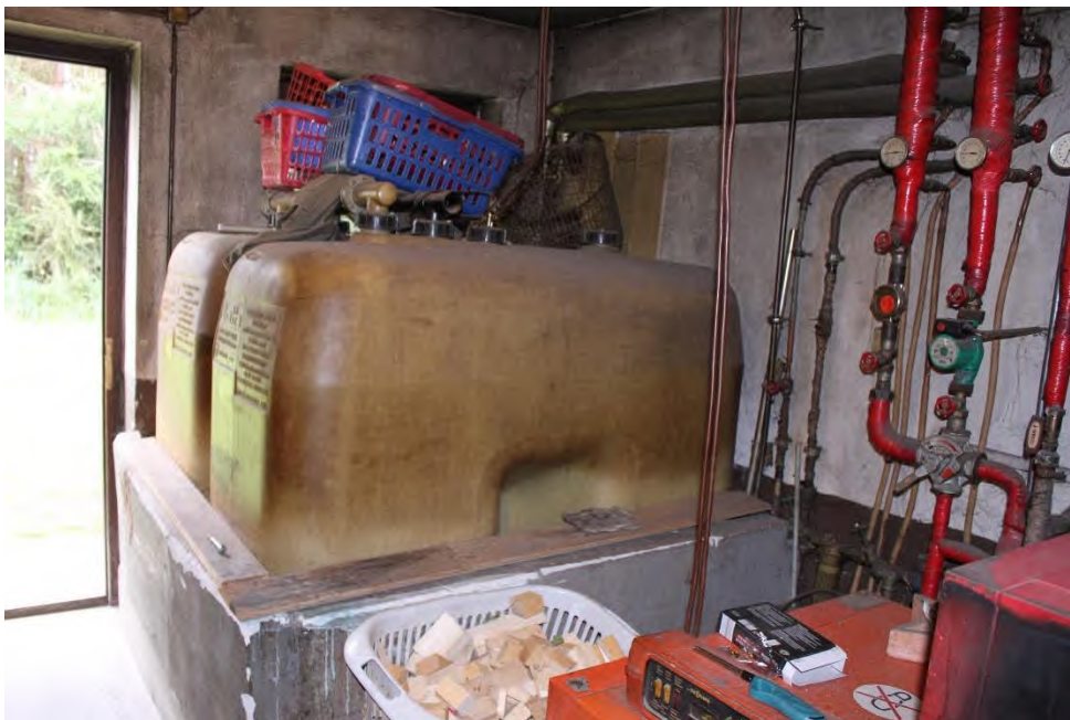
Bild 14: Öllager im Heizungsraum
