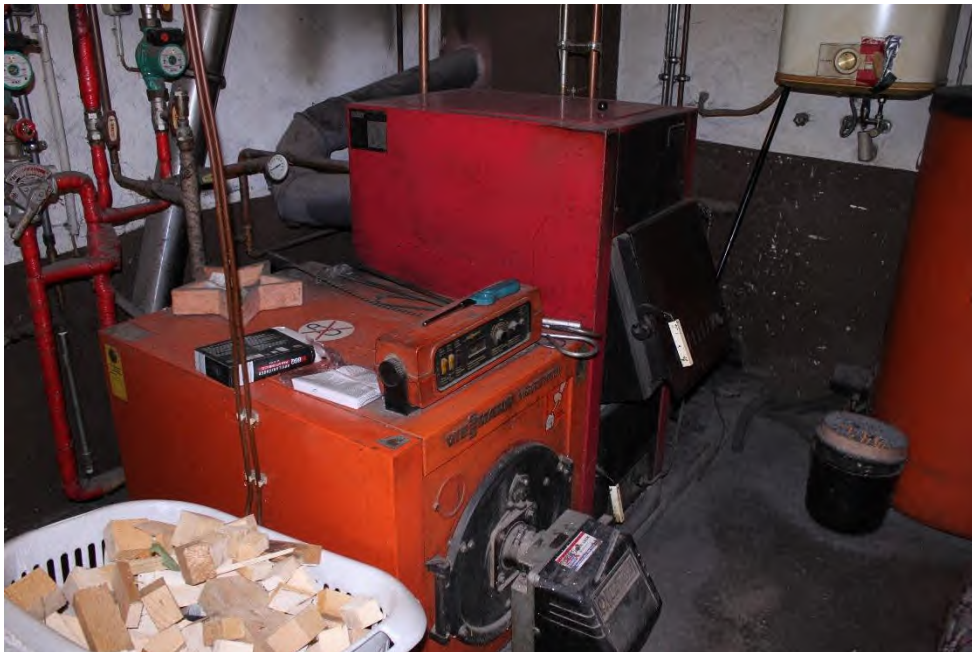
Bild 13: Heizung im EG des Wohnausanbaus 1982
