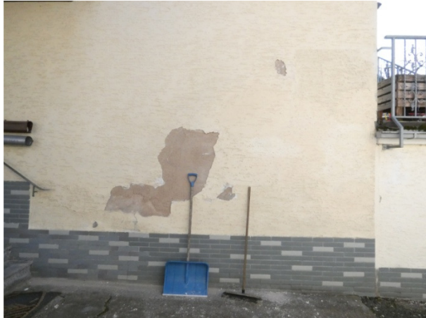
Putzschäden an der Nordfassade
