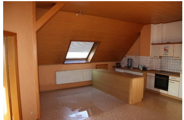
DG Wohn-Essbereich mit Wasserschaden
