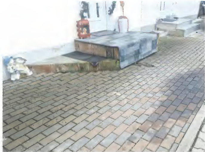
Eingangstreppe, dunkle Verschmutzungen auf dem Pflaster
