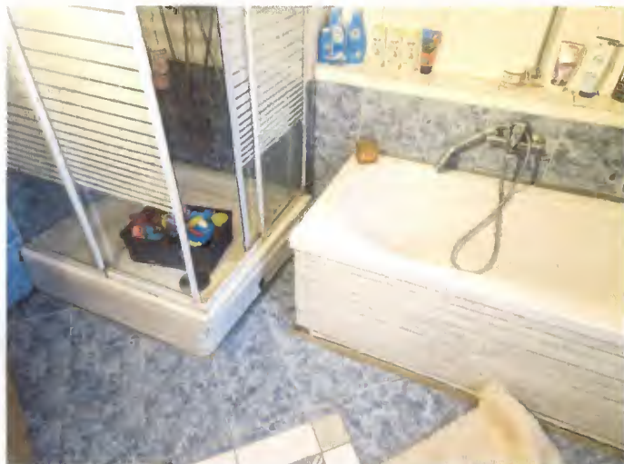
Bad, fehlende Fliesen im Sockelbereich, Spalt zur Badewanne
