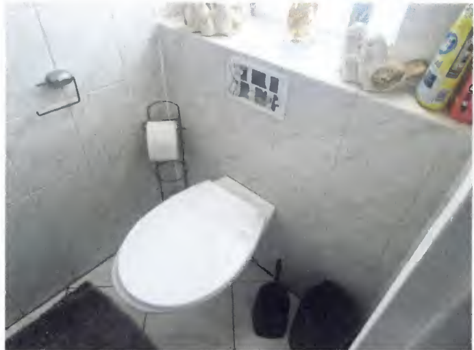
Gäste-WC, fehlender Deckel an der Spülung
