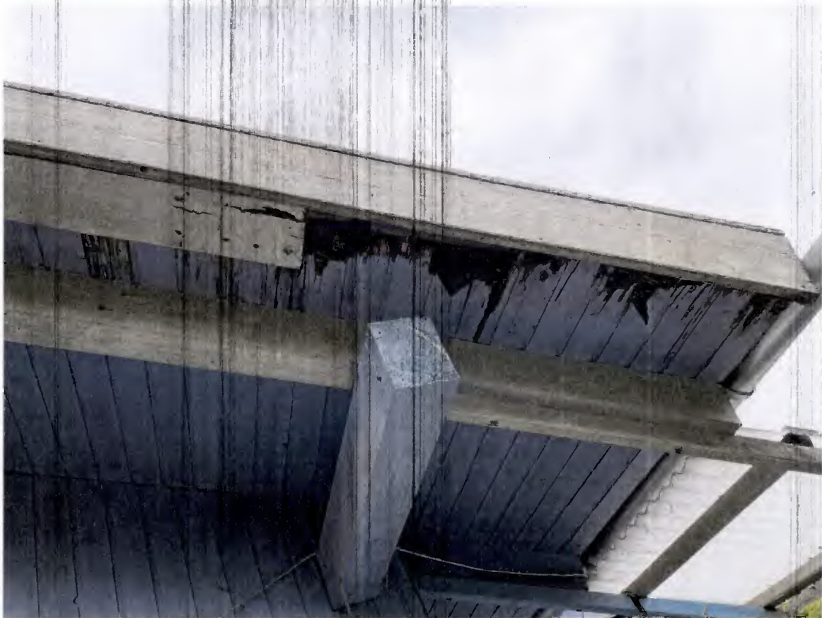
Garage Baujahr 1989 mit Feuchteschäden am Vordach
