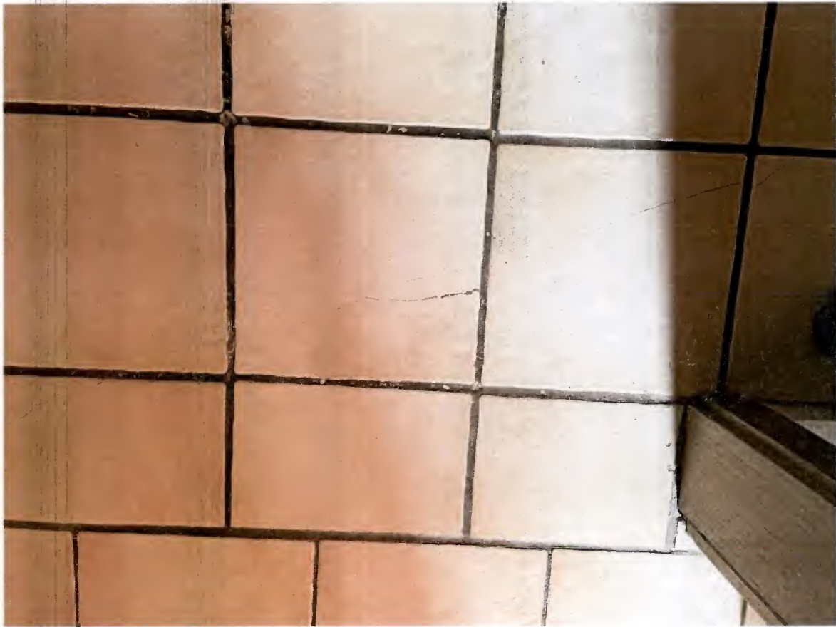
Risse im Fliesenboden
