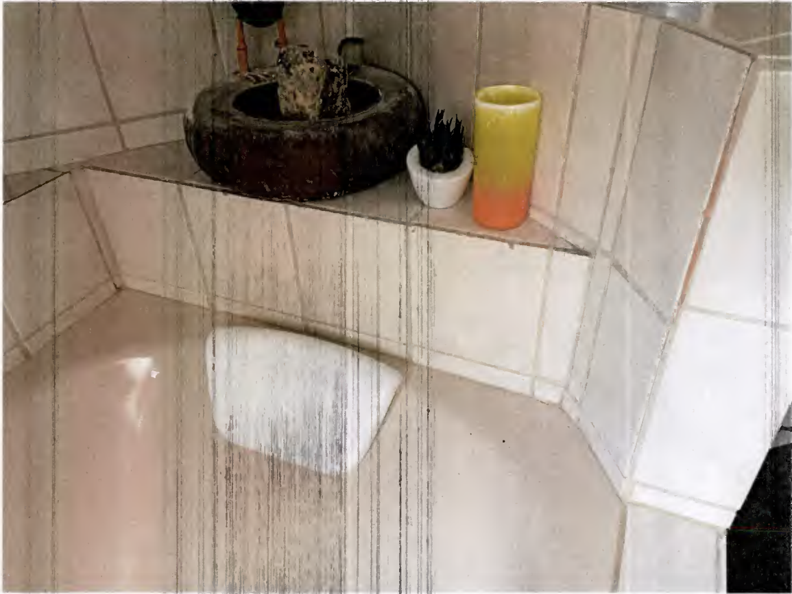
Abplatzungen an den Fliesen im Bad an der Badewanne
