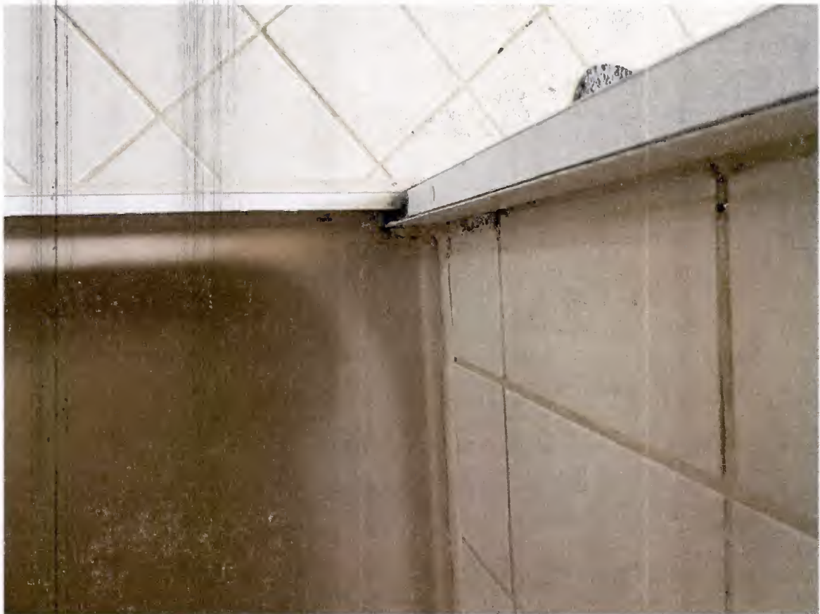
Schimmelbildung und defekte Fuge in der Dusche
