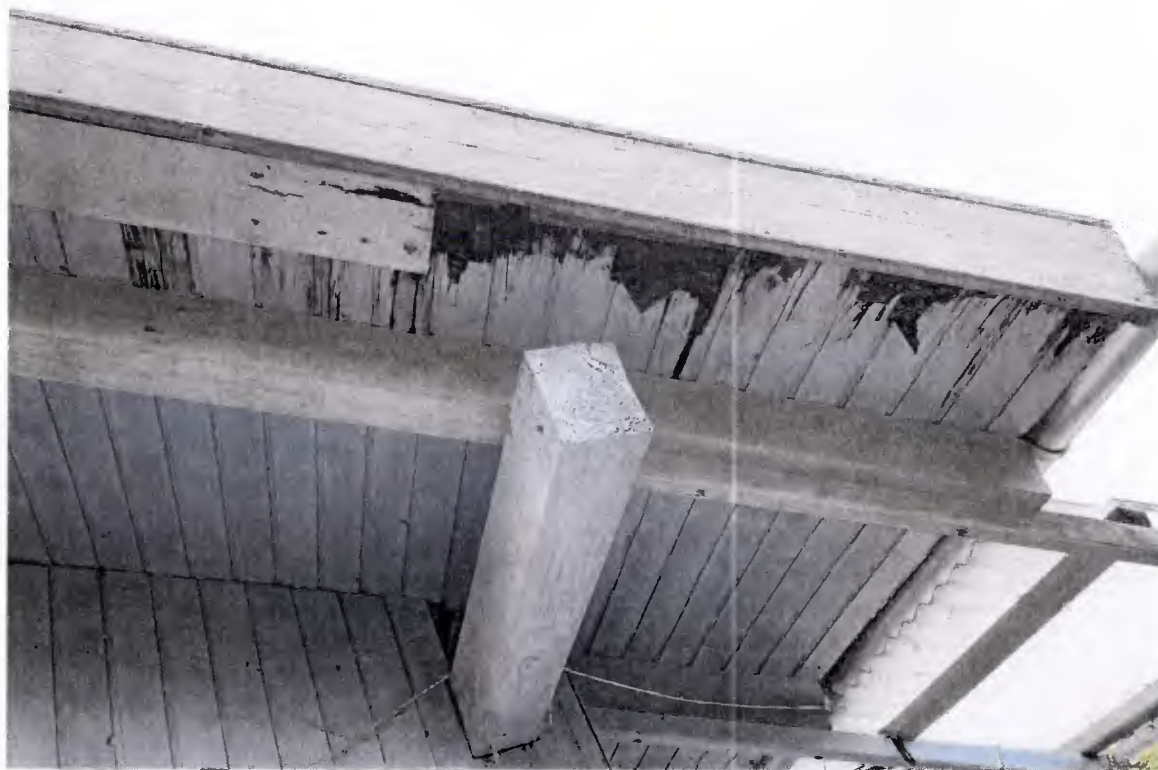
Garage Baujahr 1989 mit Feuchteschäden am Vordach
