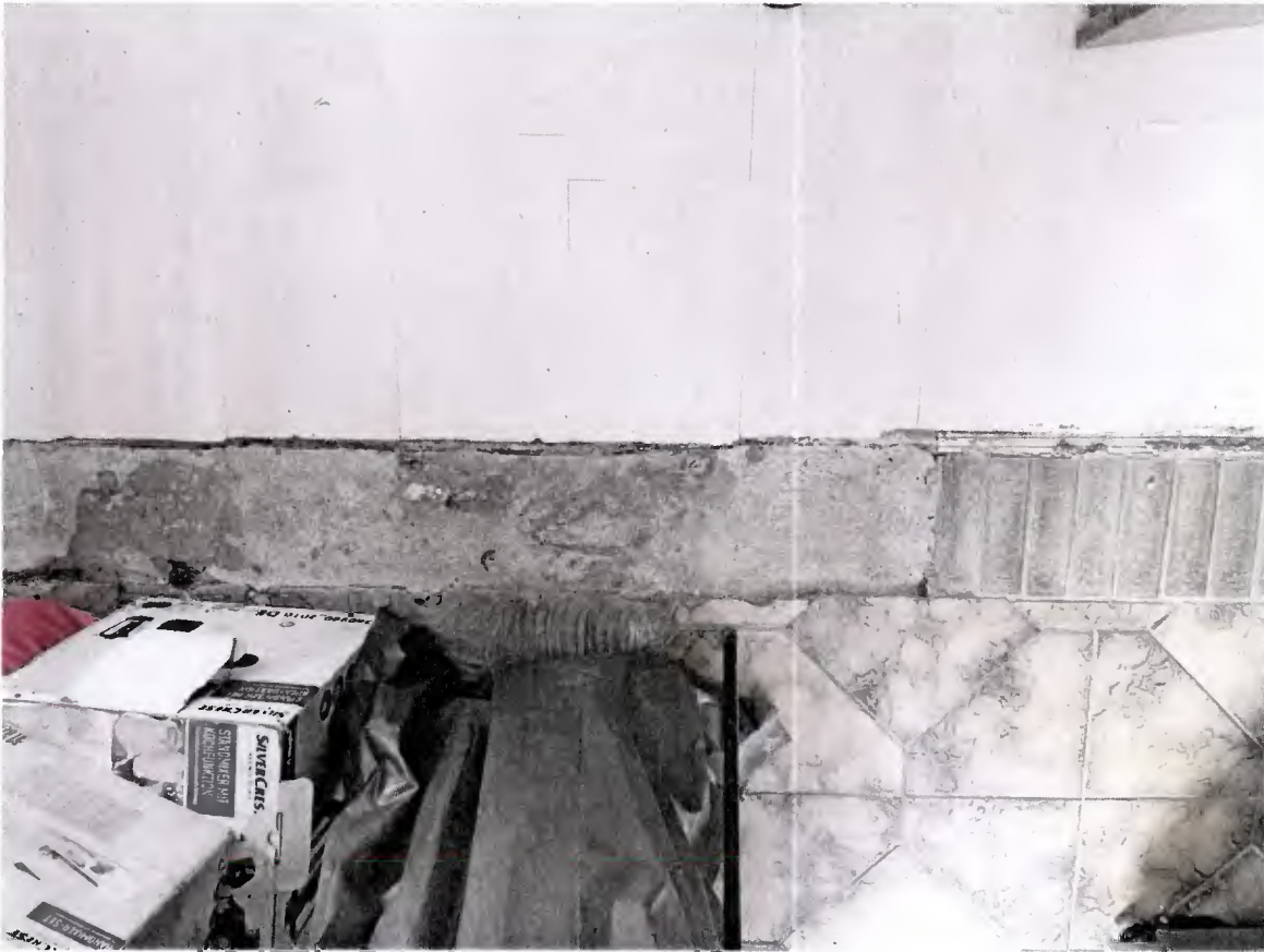
Fehlender Bodenbelag im Bereich Küche/Essen
