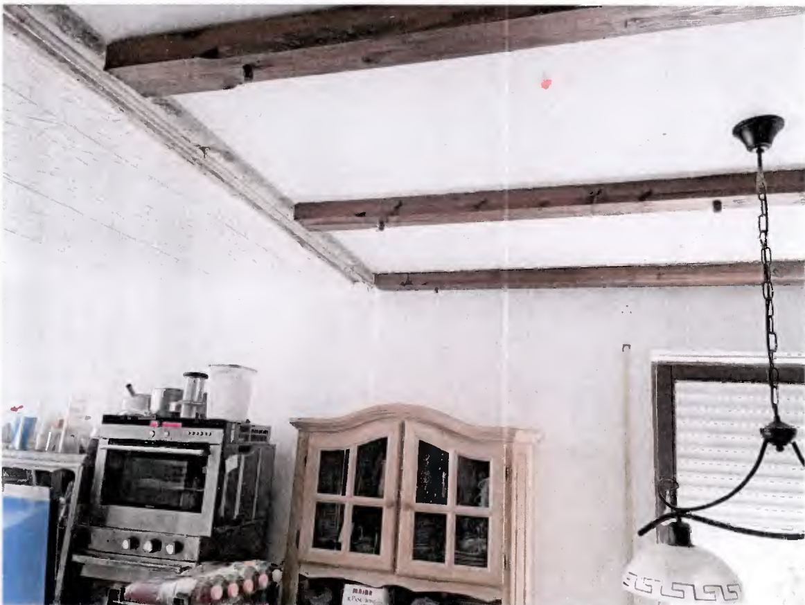
Fehlender Deckenübergang im Bereich Küche/Essen
