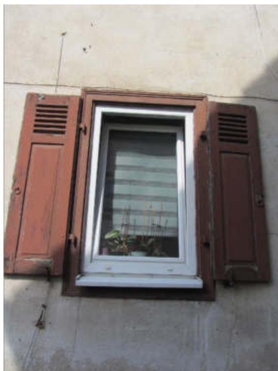
Bild 12: Zustand der PVC-Fenster
