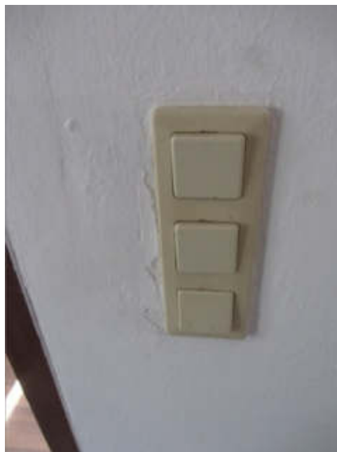
Bild 30: 1. OG: Zustand Lichtschalter
