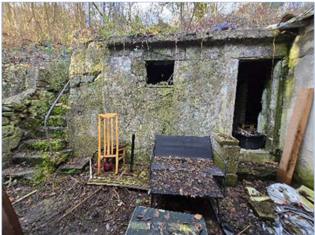
Bild 9 Baufälliger Keller, Westseite
