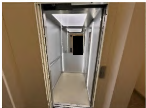
Wohn- und Geschäftshaus Gemeinschaftseigentum Aufzug
