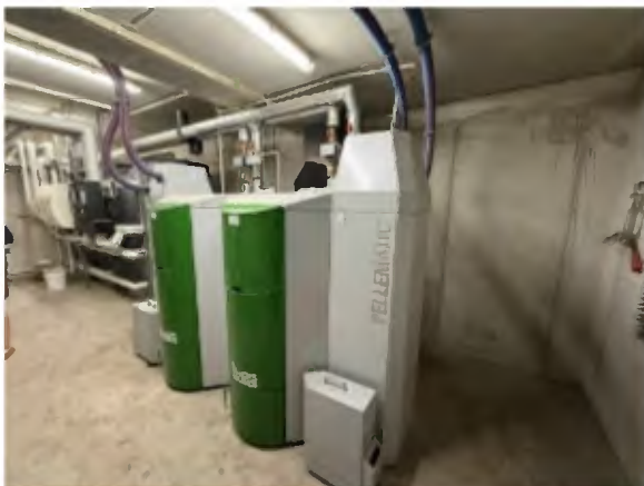
Wohn- und Geschäftshaus Kellergeschoss Gemeinschaftseigentum Heizung
