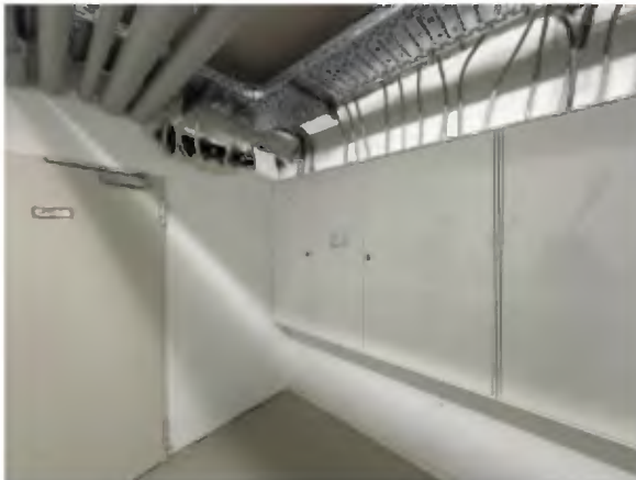
Wohn- und Geschäftshaus Kellergeschoss Gemeinschaftseigentum Hausanschlussraum
