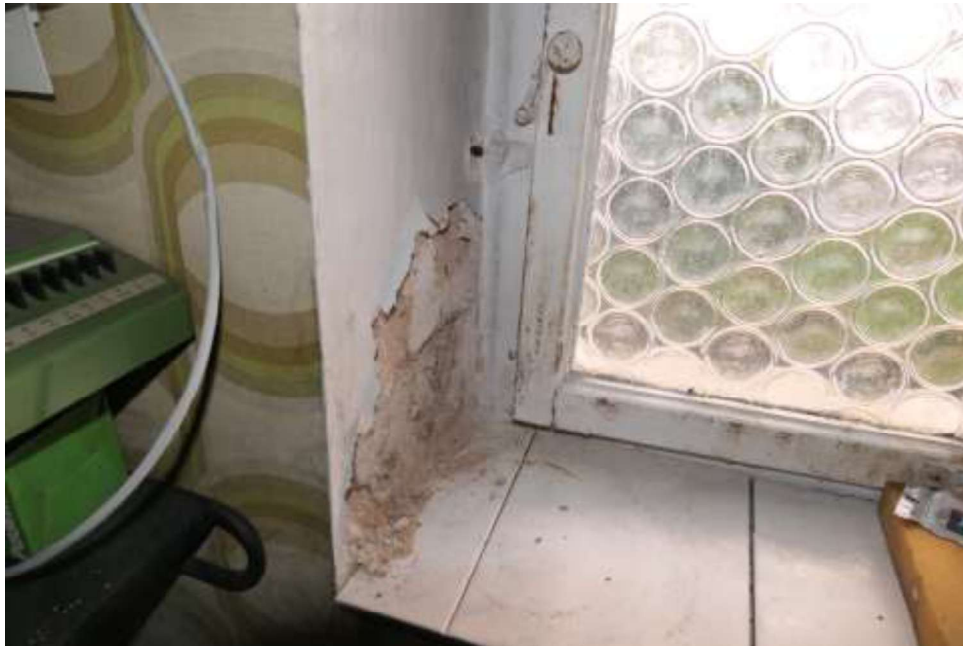
Bild 17: aufsteigende Feuchtigkeit im Kellermauerwerk
