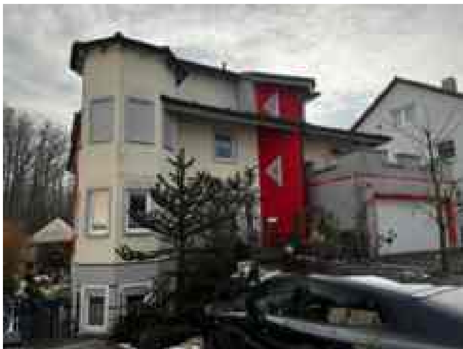
Nr. 10 Zustand Fassade
