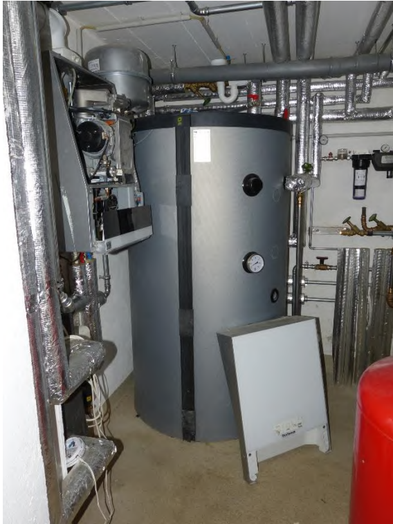
Gebäude 1: Einfamilienhaus, Innenaufnahme Heizungsraum im Untergeschoss
